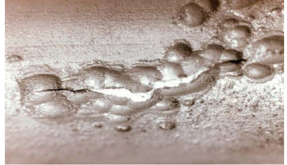
Fig.2.7 Acercamiento de tubería con ataque en forma de huella de gusano 7
