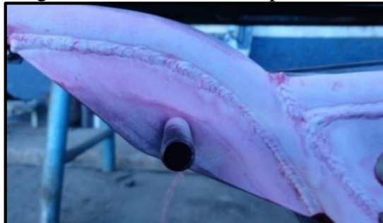
Figura 107. END refuerzos posteriores.
