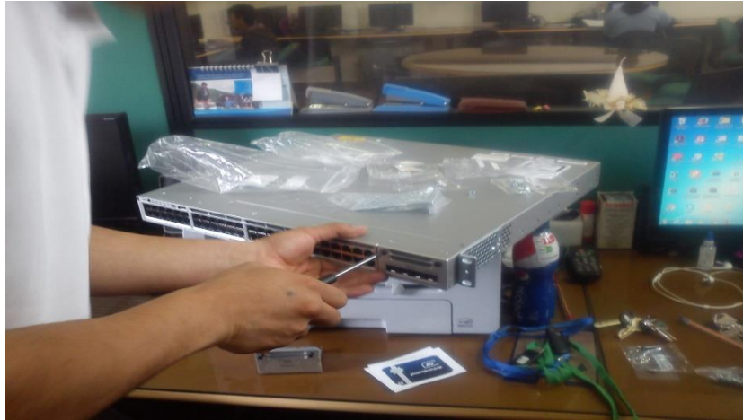
Figura 7-3: Instalación de nuevos equipos en la infraestructura física de la Espoch Realizado por: Montesdeoca, R; Alvarado A. 2017
