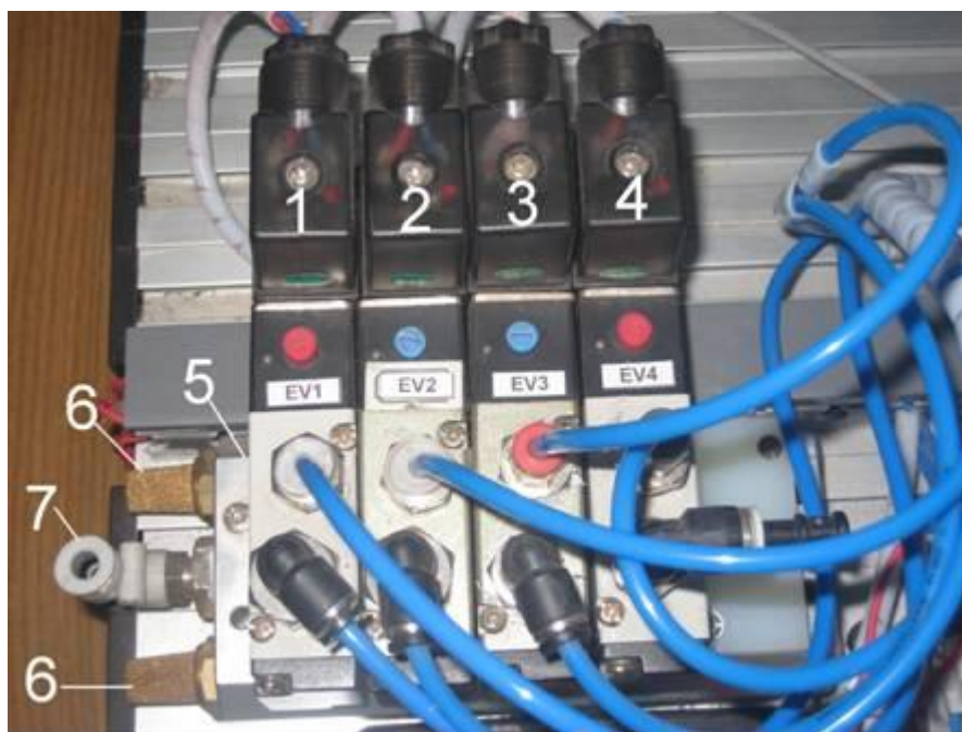
Figura 3.22. Bloque de Válvulas de Distribución.
