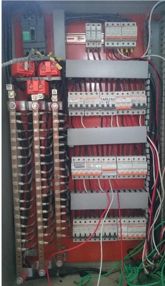
Figura 3-2 Tablero Trifásico del laboratorio Realizado por: Coronel, Boris; 2017
