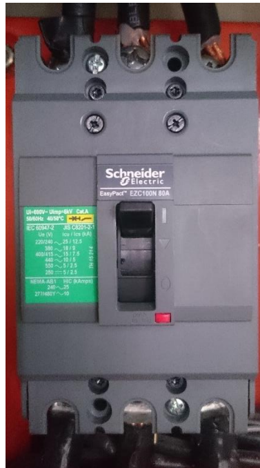
Figura 4-2 Breaker principal de 80 AMP Realizado por: Coronel, Boris; 2017
