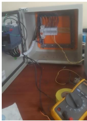
Figura 16-2 Montaje de Sentron PAC3100 en caja térmica Realizado por: Coronel, Boris; 2017
