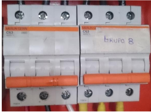
Figura 6-2 Breakers de 3 polos de 63 Amp Realizado por: Coronel, Boris; 2017
