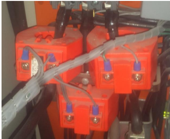
Figura 7-2 TC (Transformadores de corriente) Realizado por: Coronel, Boris; 2017
