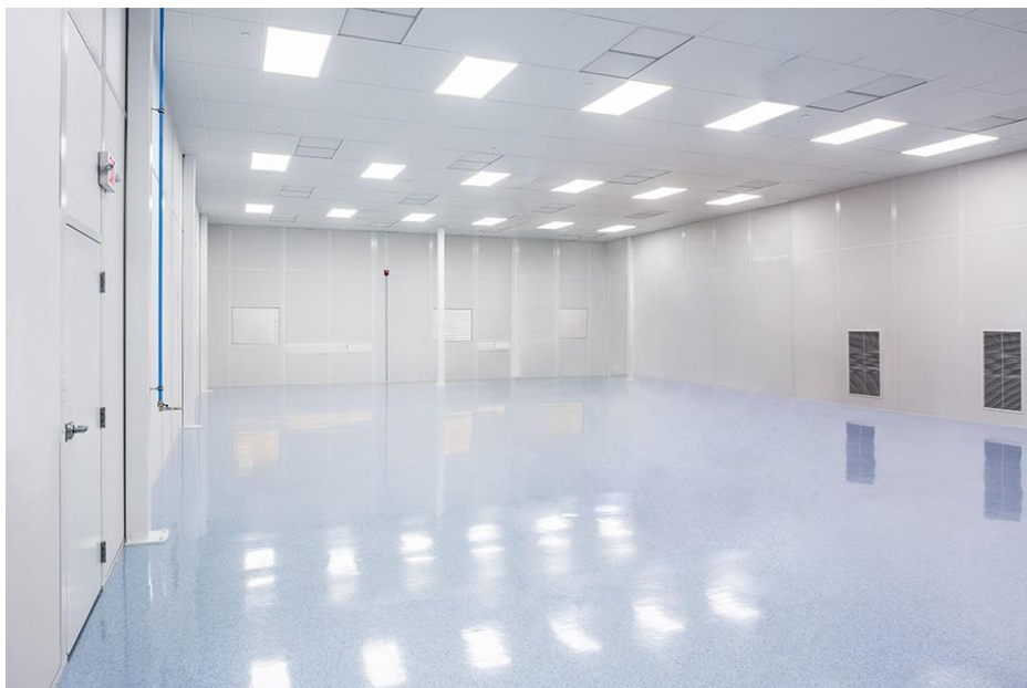
Figura 17-3: Cuarto Limpio de Paredes de Concreto
