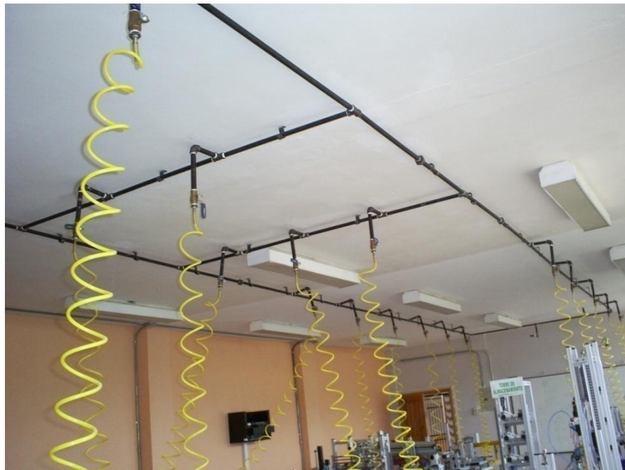
Fig. 32 Red de aire comprimido
