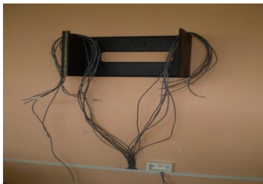
Fig. 43 Rack de pared
