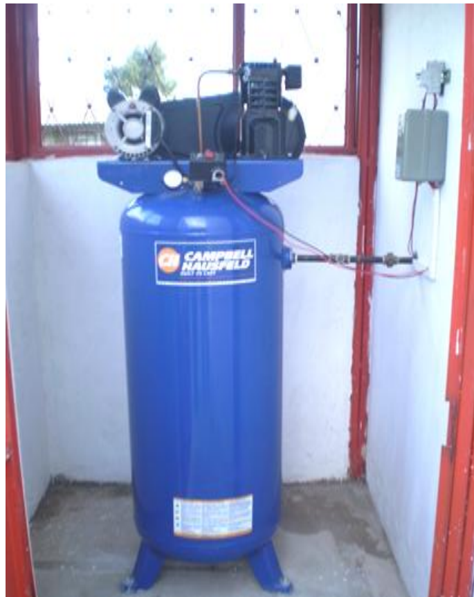
Fig. 31 Caseta del compresor
