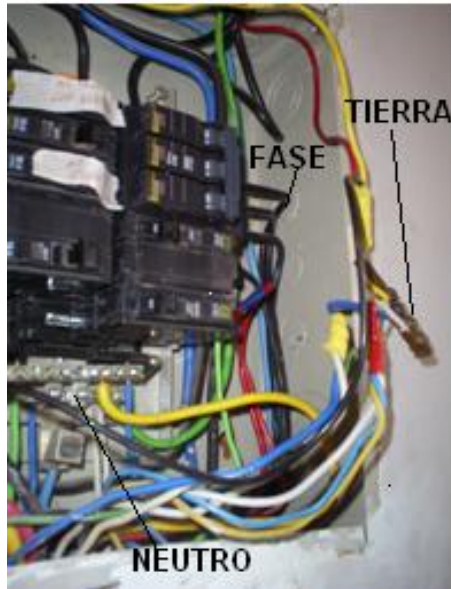
Fig. 19 Subtablero de distribución interna
