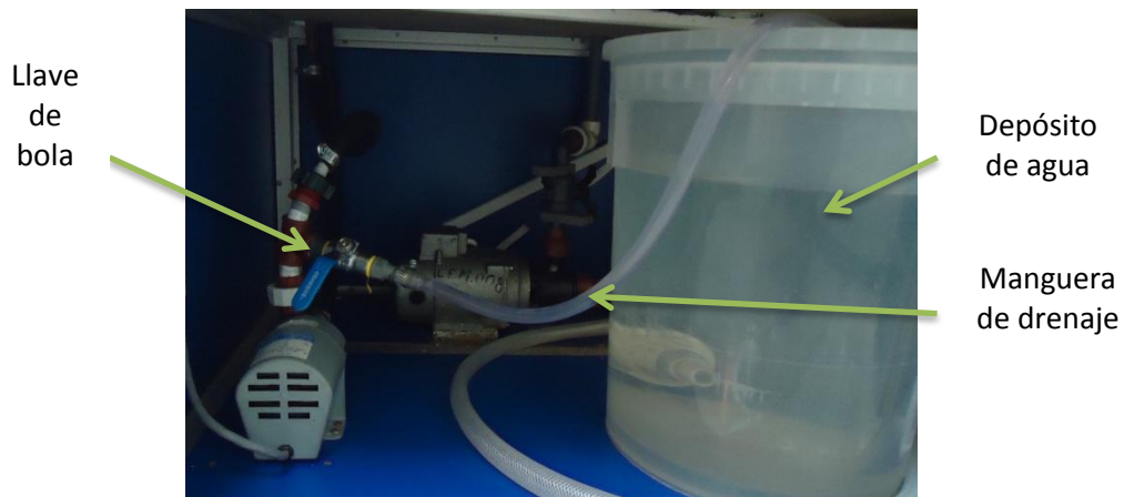
Figura 7.9. Ubicación de la bomba de recirculación
