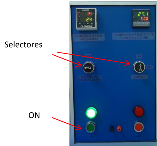
Figura 7.6. Tablero de control
