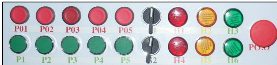
Fuente: Módulo de comunicación de variadores de frecuencia
