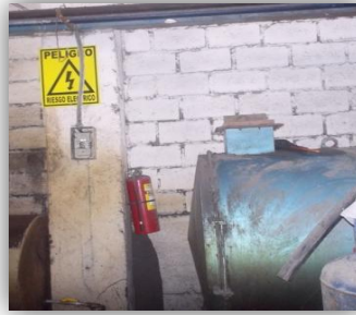
Figura 6. Área de máquinas
