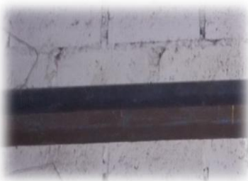
Figura 15. Inadecuada señalización de tuberías
