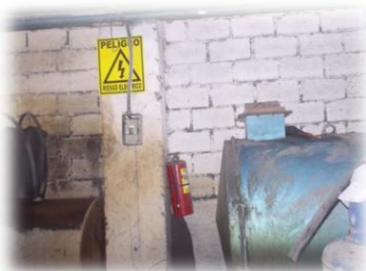
Figura 17. Señalización de extintores
