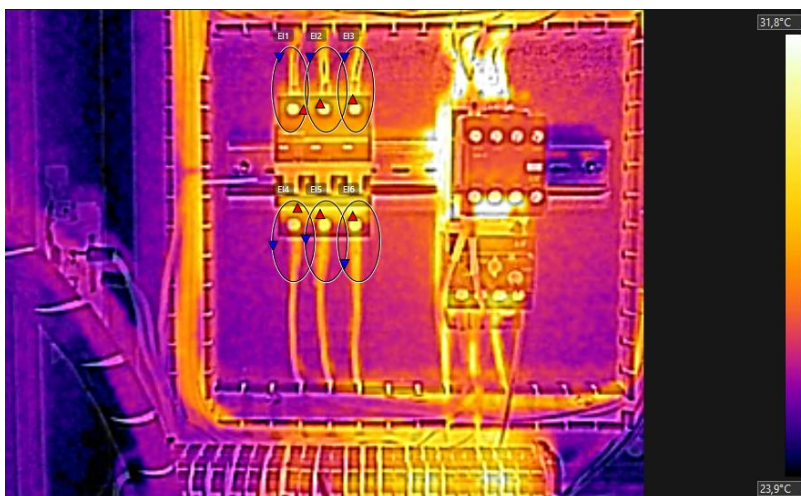
Figura 3-5. Termograma condición final interruptor secundario
