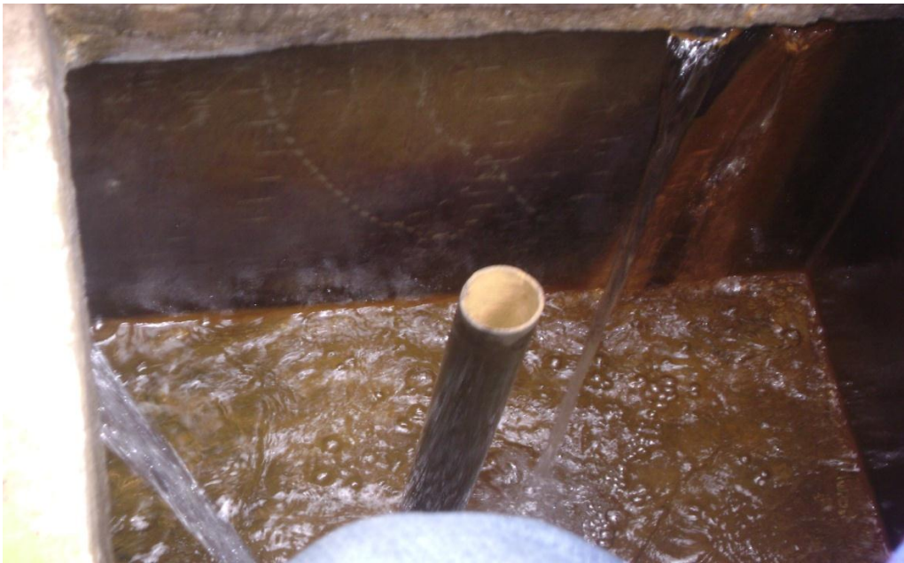
Captación del agua que conduce al reservorio
