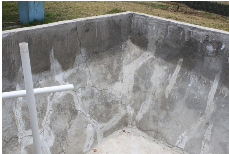
FOTOGRAFÍA N° 7 TANQUE CON FISURAS
