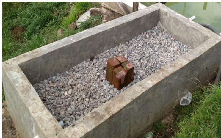
FOTOGRAFÍA N°4 BIOFILTRO CON LECHO FILTRANTE EN CAMPO
