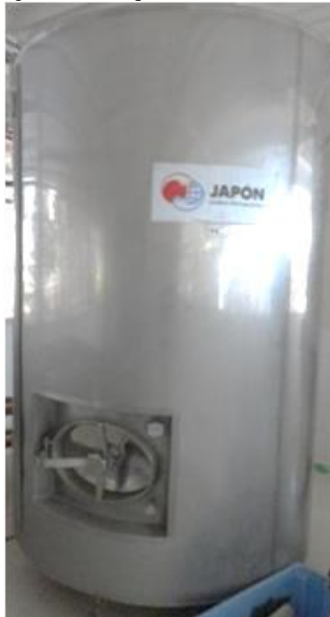
Figura 24 Tanque de almacenamiento
