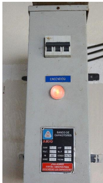
Figura 18. Banco de condensadores
