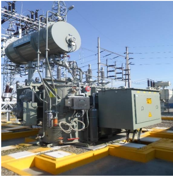
Figura N° 3: Transformador de potencia 15/20/25 MVA
