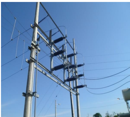
Figura N° 5: Seccionador de 69 KV
