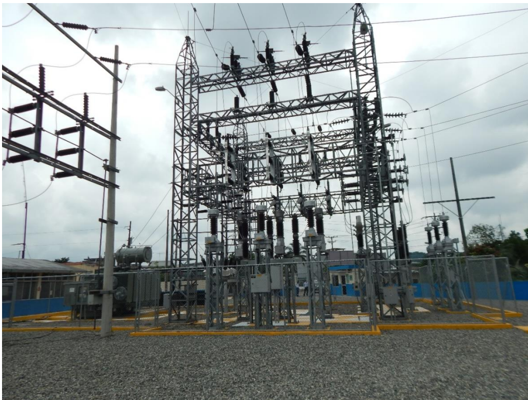
Figura N° 2: Área Subestación Lago Agrio
