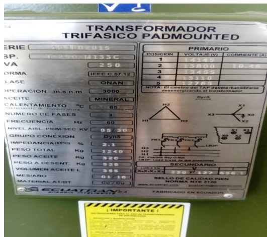
Figura N° 6: Transformador de servicios auxiliares
