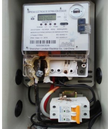
Figura 17: Bornera quemada en el medidor de energía
