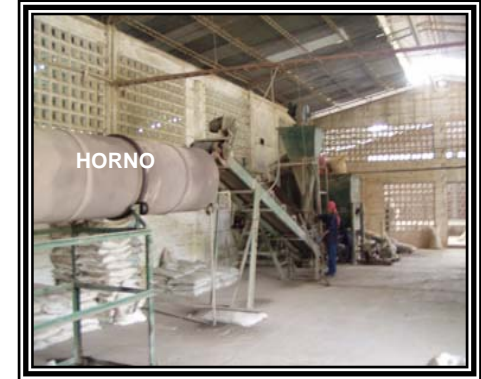
Punto 7 Inta: Generación de vapores en el proceso de secado en el Horno rotatorio.
