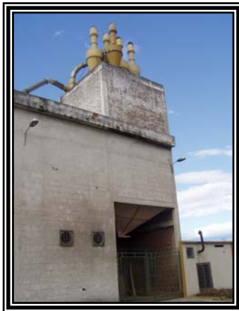
Punto 3. Trilladora de Café Angélica: Generación de MP en el momento de recolección de los residuos al camión de recolección.
