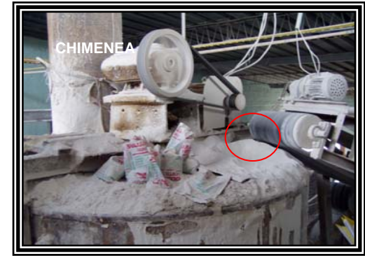
Punto 9.1 Minero Providencia: Generación de MP y vapores en el proceso de dosificación de dolomita al rector de la planta de Sulcamag
