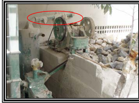
Punto 6.1 Dolomita el Fraile: filtros de manga fuera de funcionamiento.
