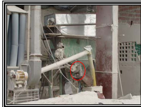
Punto 9 Minero Providencia: Generación de MP Operación en la cual la banda deposita el material al molino a la planta triturado de Dolomita.
