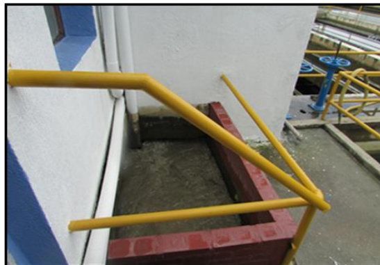
Imagen 3. Cámara de llegada del Distrito de Coello a la PTAP. Fuente: Autores.
