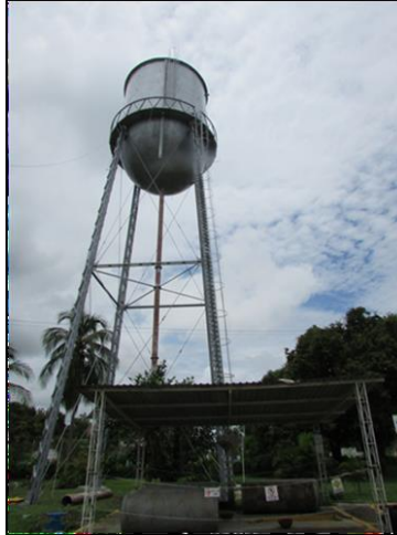
Imagen 8. Tanque elevado de tipo “Insfopal” en la PTAP Fuente: Autores.
