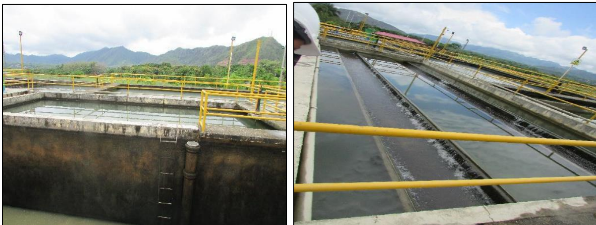
Imagen 6. Unidades de sedimentación de la planta de potabilización Fuentes: Autores.
