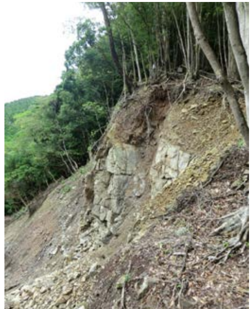
写真6 傾斜計⑧を設置した砂岩ブロック Photo 6 Sand stone mass with tilt meter ⑧.
