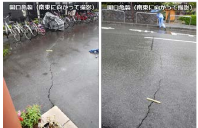
図6 健軍神社西側(図2地点B)の上下変位を伴う開口亀裂
