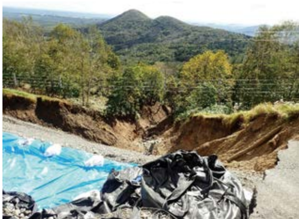
写真9 狩勝峠の十勝側7号目付近における厚い斜面堆積物の崩壊・浸食 国道の片側車線が崩落した。
