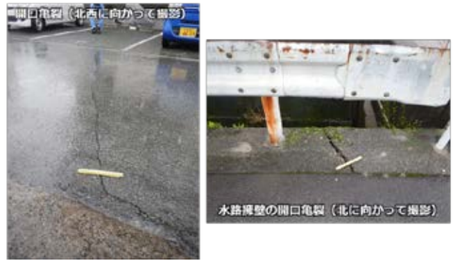
図5 水前寺公園西側(図2地点A)の開口亀裂
