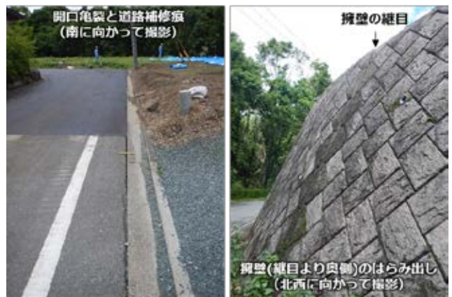
図7 熊本市の宅地盛土(図4地点A)の地表変形
