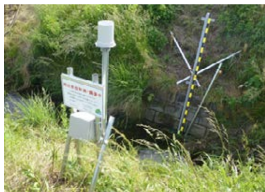
図2 簡易水位モニタリングシステム概観
