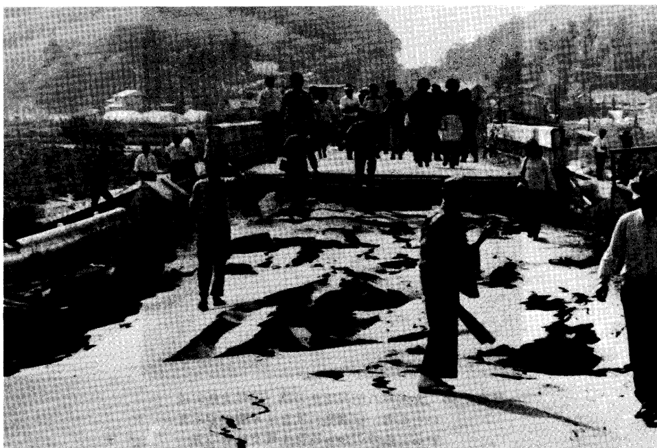
写真 4.20 大瀧村五明光橋 大瀧村側から五明光側に向かって見る. 橋取付部の路面沈下は約 50 ~ 60 cm ぐらいか.
