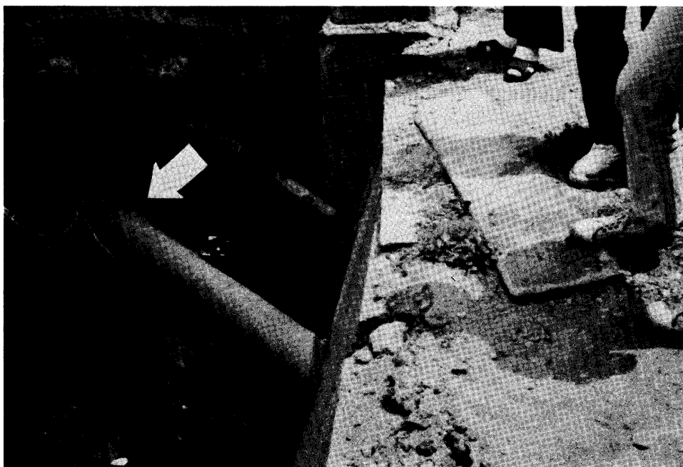
写真 5. 39 深浦町苗代沢吾妻橋(国道 101 号). 津波のために矢印のところでパイプが破損したといわれる. 5 月 31 日 11 時 50 分撮影.
