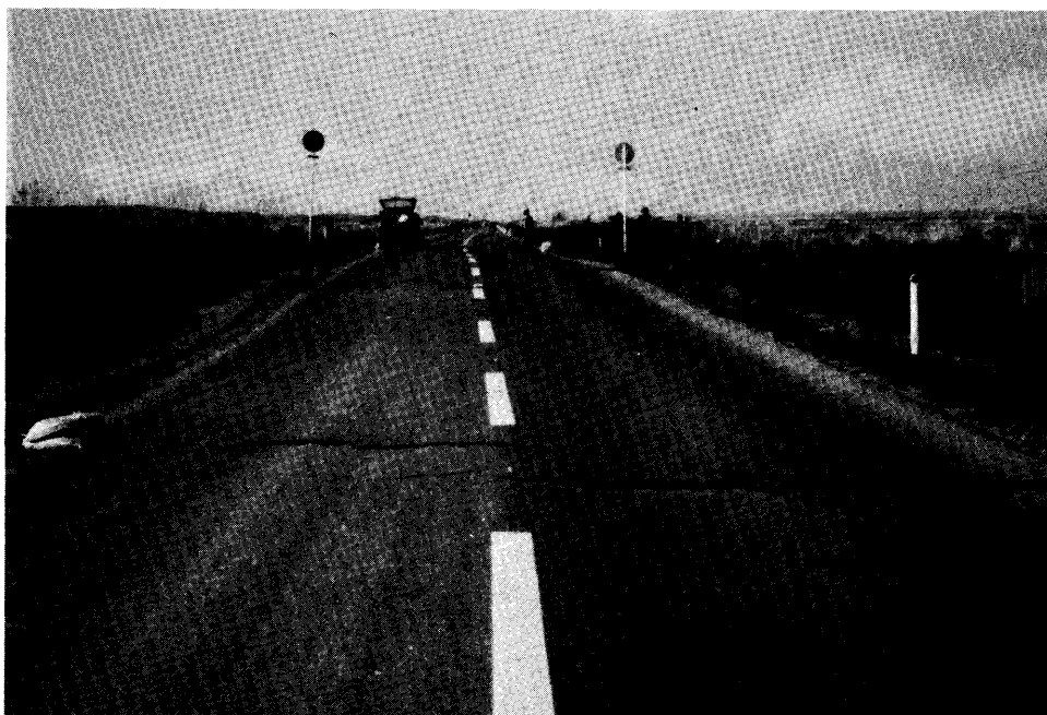
写真 4.16 大潟村西部承水路 道路が上下左右に波打ち、キ裂が道路を横断している.
