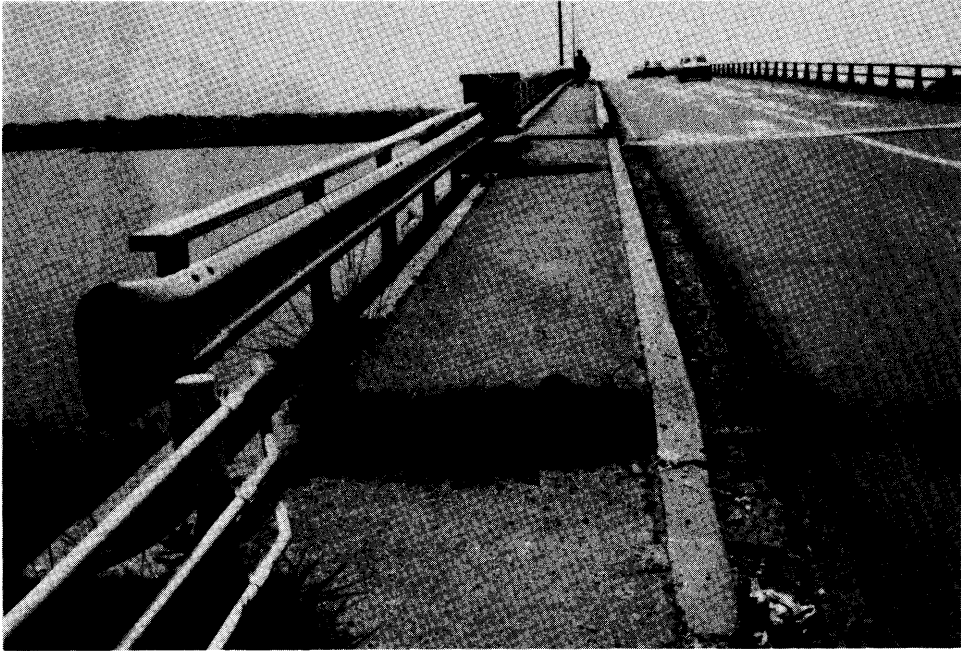
写真 4.7 男鹿大橋 男鹿市側の取付部に段差が発生.
