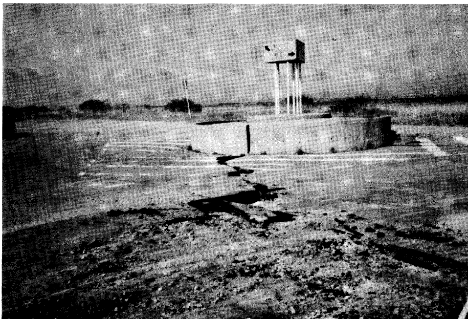
写真 4.15 大潟村 村内の道路に発生したキ裂.
