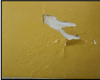
Imagem 1 – Gretamento e descolamento do revestimento
