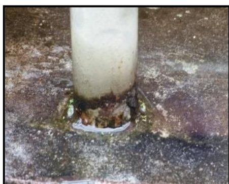
Imagem 5 – Corrosão e oxidação
