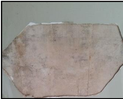
Imagem 3 – Desagregação com descolamento do revestimento
