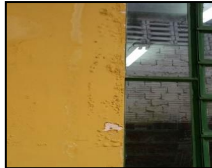
Imagem 4 – Umidade de Infiltração
