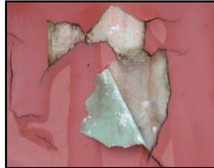
Imagem 2 – Descamação e mofo da pintura
