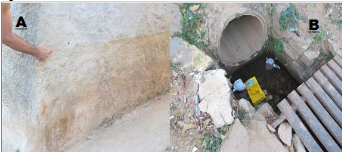
Figura 1 – (A) Elevação do nível da água no período de chuvas intensas. (B) Precariedade do sistema de drenagem e falta de educação da população.
