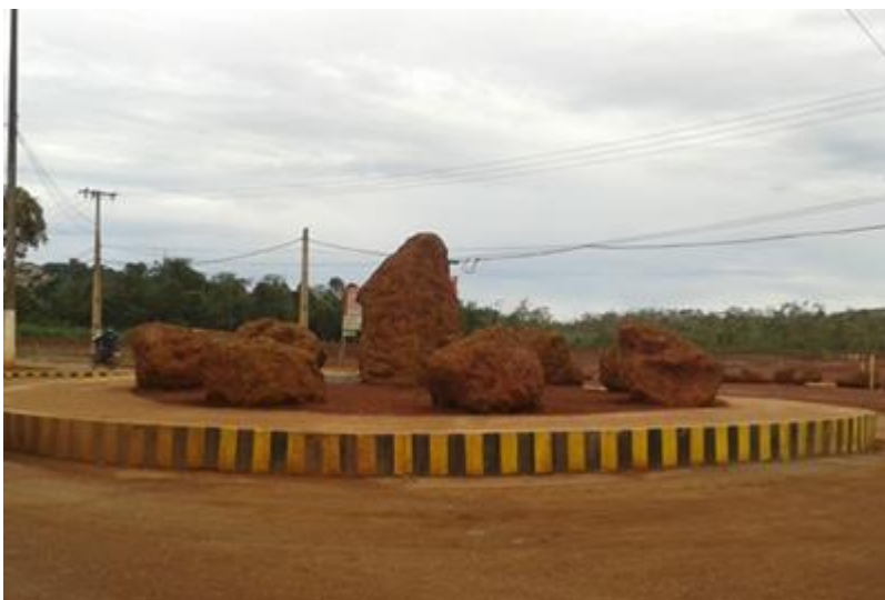
Figura 02 - Anel viário em fase de construção, rotatória na Rua Pedro Gomes com Avenida Perimetral, início do anel viário. Fonte: Morais, 2013.
