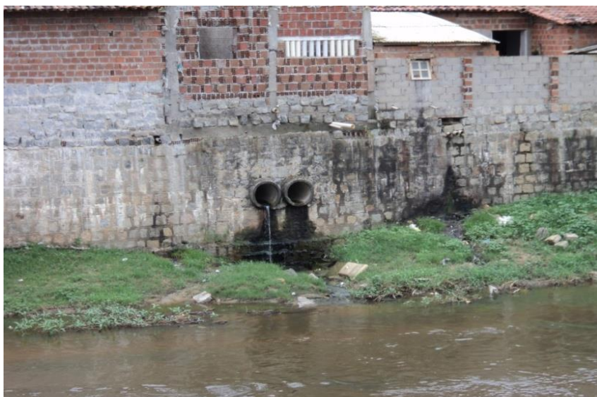
Figura 6: Efluentes domésticos e esgotos direcionados para o leito do rio. Fonte: Acervo dos autores, 2012.
