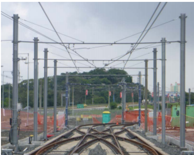
Figura 3. Postes de soportar catenarias. Ingeniería conceptual Línea 2. Especificaciones funcionales, técnicas y contractuales. Tomo II. Equipamientos [37].
