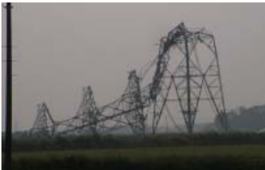
写真 3 香取線 24号鉄塔
