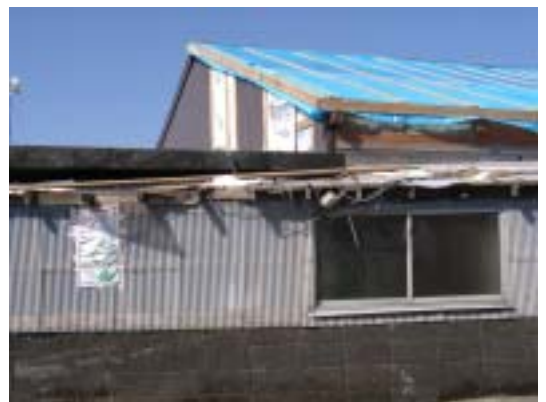
写真23 北東側 屋根、庇の被害
