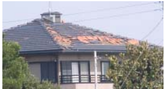
写真 14 香取線 24 号鉄塔付近の住宅屋根瓦の飛散
