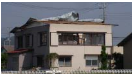
写真 18 住宅屋根材の飛散 (住宅 B)
