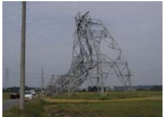
写真 7 香取線 21号鉄塔
