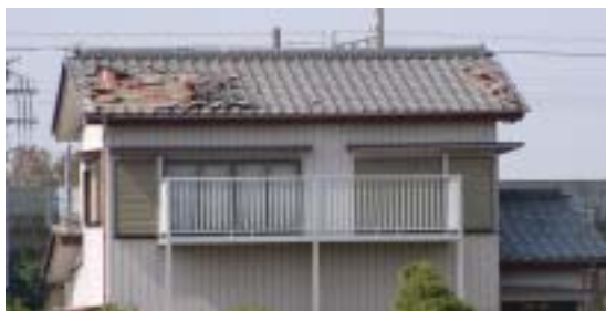
写真 19 住宅屋根瓦の飛散 (住宅 C)
