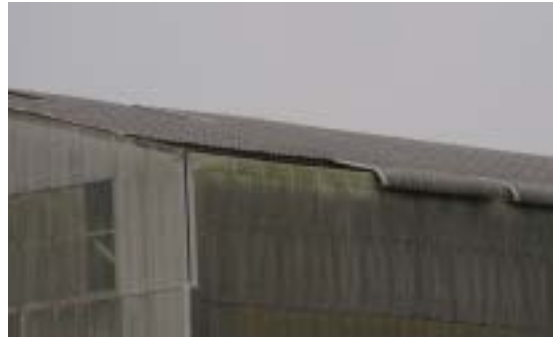
写真 13 香取線 21 号鉄塔付近の工場屋根材の飛散
