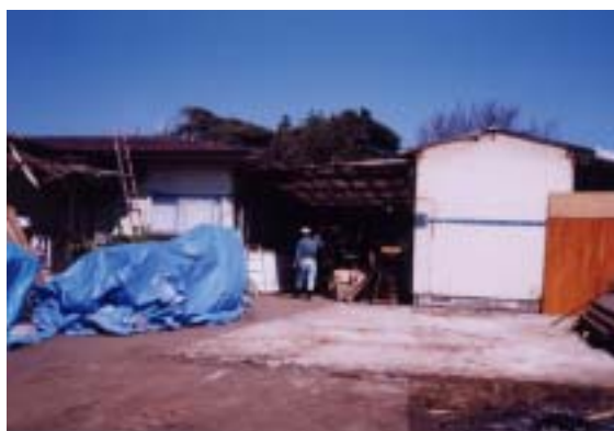
写真 29 宿泊施設から東約 200m の場所で倉庫が 傾き家屋に寄り掛かった。調査時点では倉庫は撤去 されていた。(基礎のコンクリートが残る)
