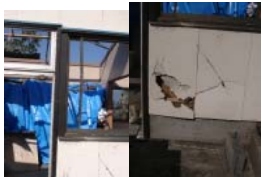
写真25 宿泊施設の窓ガラス, サッシ被害 宿泊施設の外壁に残る飛散物衝突跡
