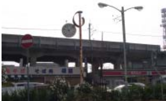
写真 20 潮来駅前時計の被害
