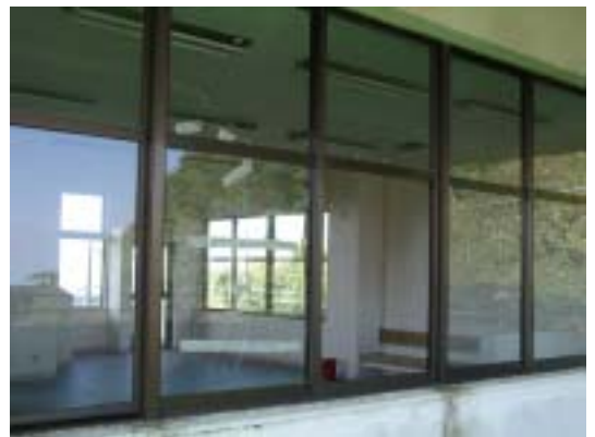
写真22 展望台北東面の窓ガラスの被害
