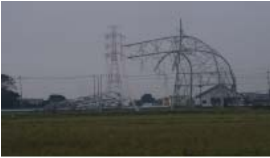
写真 2 香取線 25号鉄塔
