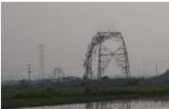
写真 4 香取線 23号鉄塔
