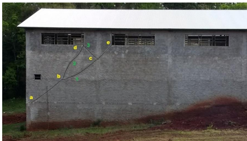
Fig. 3 – Mapeamento das Fissuras
