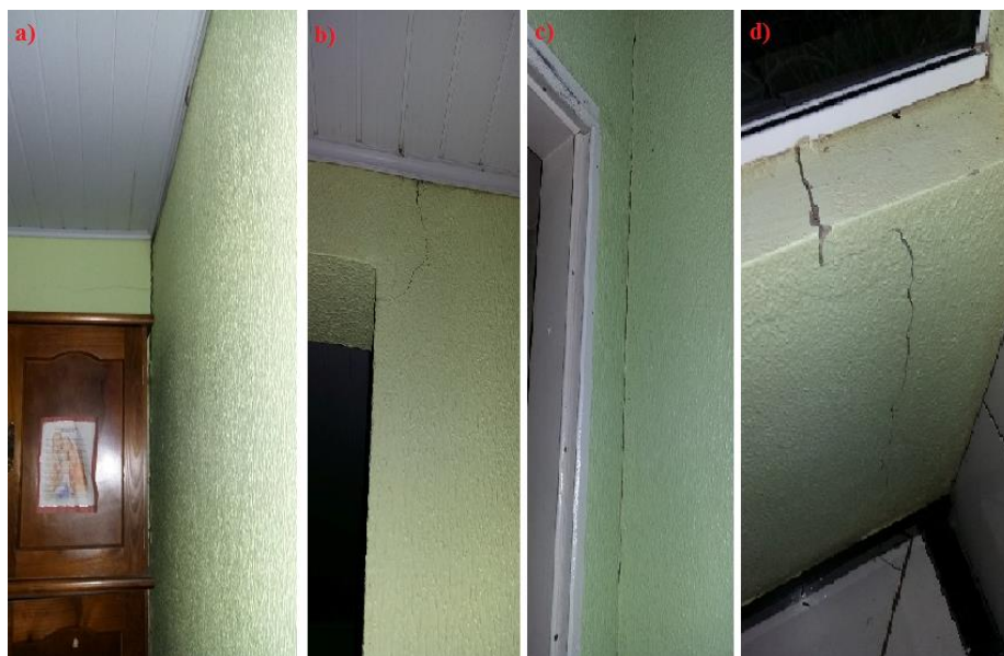
Fig. 5 – a) Fissura 02 – vertical no dormitório; b) Fissura 03 – entrada da sala; c) Fissura 04 – porta do dormitório; d) Fissura 05 –
