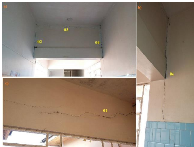
Fig. 1 – a) Fissuras Horizontais e Verticais; b) Detalhe da Fissura 04; c) Detalhe da Fissura 01
