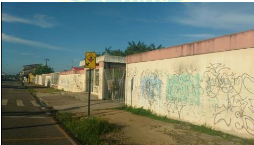
Figura 3 – Muro da Escola Estadual de Ensino Fundamental e Médio Professor Antonio Gondim Lins, bairro Paar, Ananindeua/PA. Foto: SOUZA, A. L. F., 2017.
