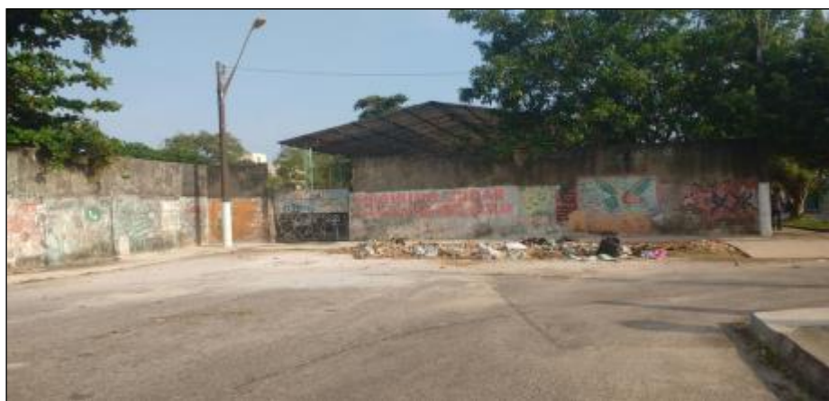
Figura 1 – Muro com marcas de elevação de sua altura (recente) da Escola Luís Nunes Direito.
