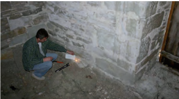
Fig. 11. Hamra kyrka. Provtagning i Hamra kyrkas torn. Utvisar positionen för prov Hamra 008, som ligger på en lägre nivå än Hamra 006 och 007. Foto: ÅR 2006.
