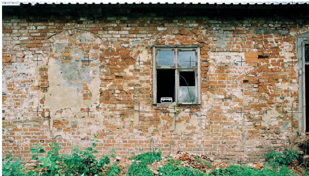
Fig. 1. Et i Østtyskland ikke længere almindeligt syn: Et senmiddelalderligt adeligt stenhus (engang familien Wencksterns sæde, i Kietz ved Elben, upubliceret), skjult gennem århundreder i en afsides flodeng. Nu skal det vurderes. Ejernes ønske om at nedrive er afvist, og ruinen er igen under tag. Men hvilken af de mangfoldige detaljer vil overleve en restaurering? Dokumentationen bliver om få år deres eneste levn. Hvad skal altså laves?
