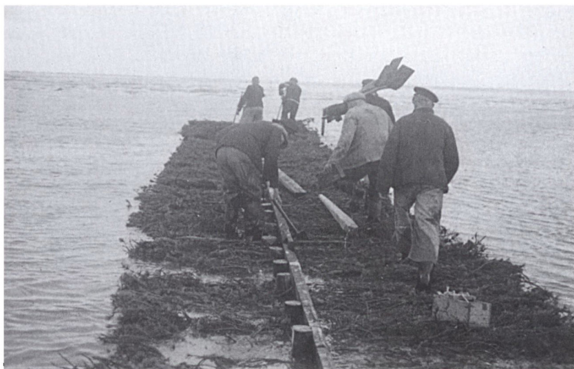
Tippen« – dæmningens forreste arbejdsplads. Her lægges der faskinmætter (granris) ud som underlag for dæmningsfyldet. Billedet er fra 1940. Foto: Museum Sønderjylland – Skærbæk.
