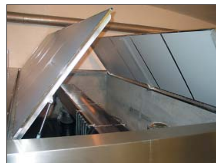
Et kig ned i et sandfilter på et vandværk. (Foto: Odense Vandselskab as)
