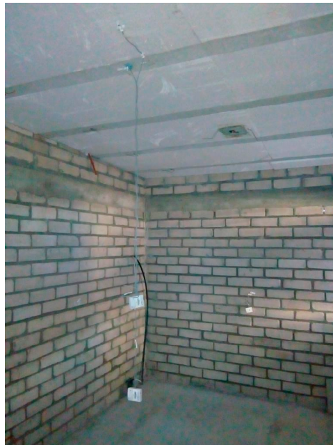
Figura 6. Cubierta de viguetas de concreto armado y casetones de poliestireno expandido, también puede apreciarse los muros de BTC, con estructura de concreto armado.
