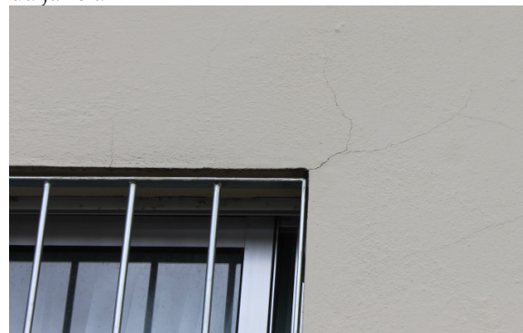
Figura 10 – Fissuras inclinadas no canto superior da janela
