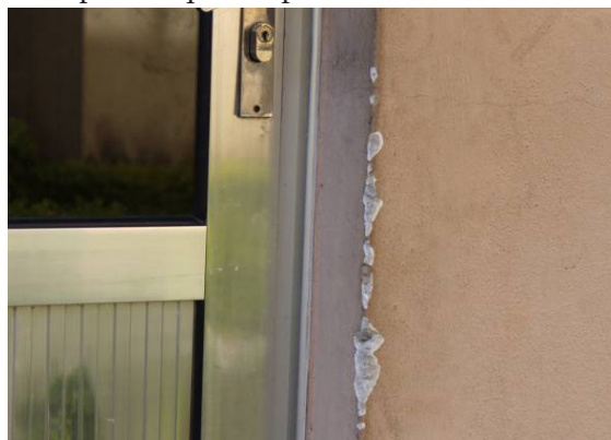
Figura 31 – Descolamentos de revestimento causados por choques/impactos
