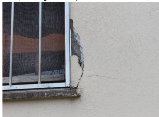
Figura 29 – Descolamento em placa resultante da instalação de grade na janela
