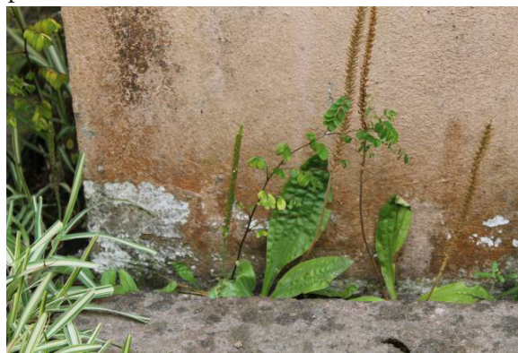
Figura 33 – Descolamento de revestimento com pulverulência
