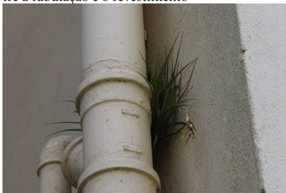
Figura 22 – Vegetação parasitária localizada entre a tubulação e o revestimento
