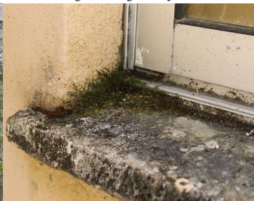
Figura 19 – Musgos e fungos no peitoril
