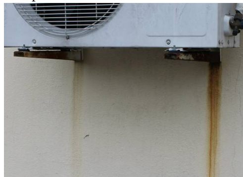
Figura 27 – Manchas de corrosão geradas a partir do suporte do condicionador de ar
