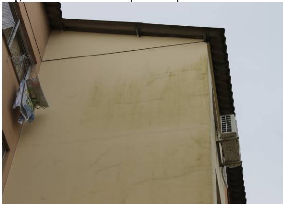
Figura 16 – Limos na parte superior da fachada
