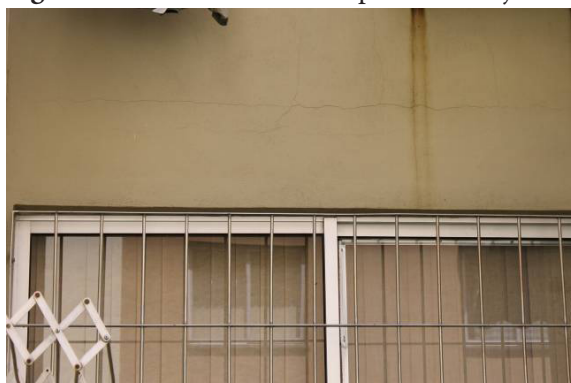
Figura 8 – Fissura horizontal próxima à laje
