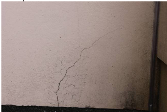
Figura 11 – Trinca inclinada próxima a viga de fundação
