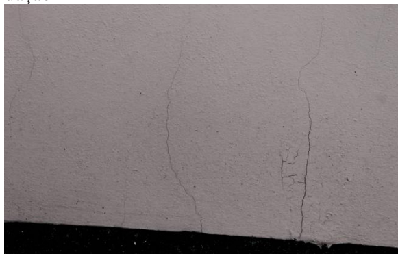
Figura 9 – Fissuras verticais sobre a viga de fundação
