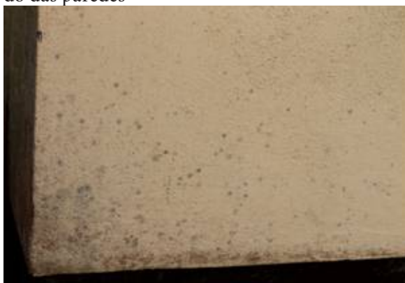
Figura 14 – Fungos no revestimento argamassado das paredes
