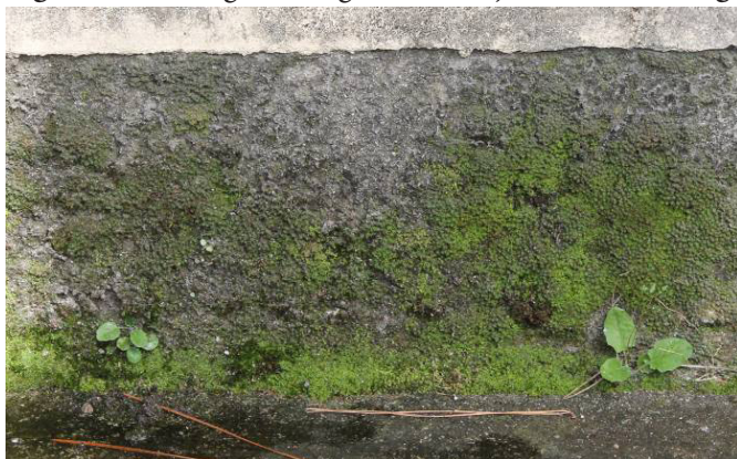
Figura 18 – Musgos na viga de fundação
