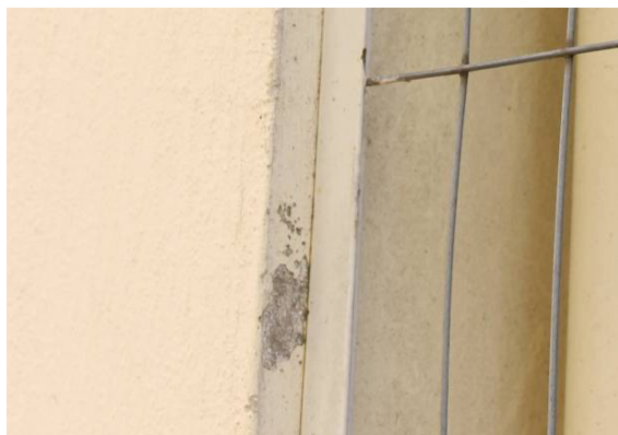
Figura 32 – Descascamento de pintura no revestimento
