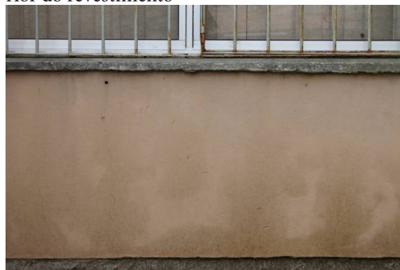
Figura 23 – Manchas de umidade na parte inferior do revestimento
