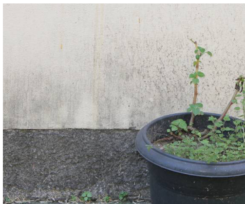
Figura 24 – Sujidades na viga de fundação e no revestimento
