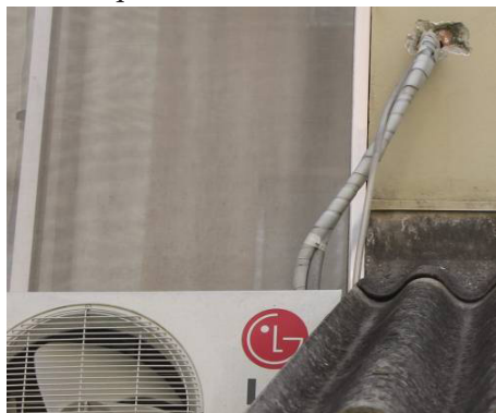
Figura 28 – Descolamento em placa devido à instalação inadequada do condicionador de ar
