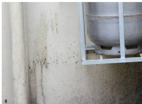
Figura 26 – Escorrimento de elementos orgânicos
