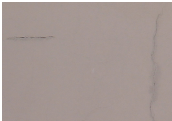
Figura 7 – Fissuras horizontais e verticais no revestimento
