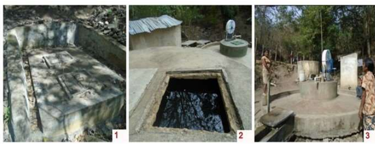
Figura 1. Se muestran los diferentes puntos monitoreados en la comunidad El Cacao. 1. Pila de captación, 2. Tanque de almacenamiento, 3. Llave de chorro.
