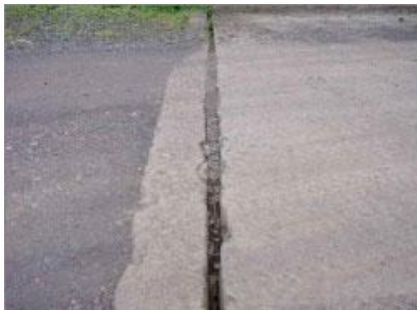
Figura 7. Deterioro de junta.
