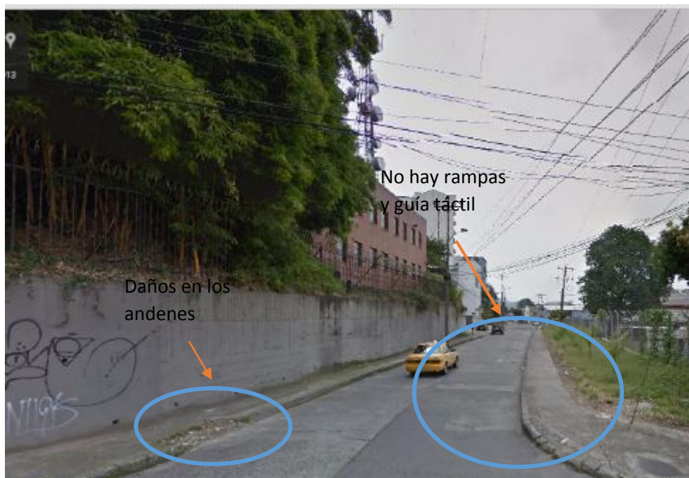
Figura 34. Estado de los andenes.
