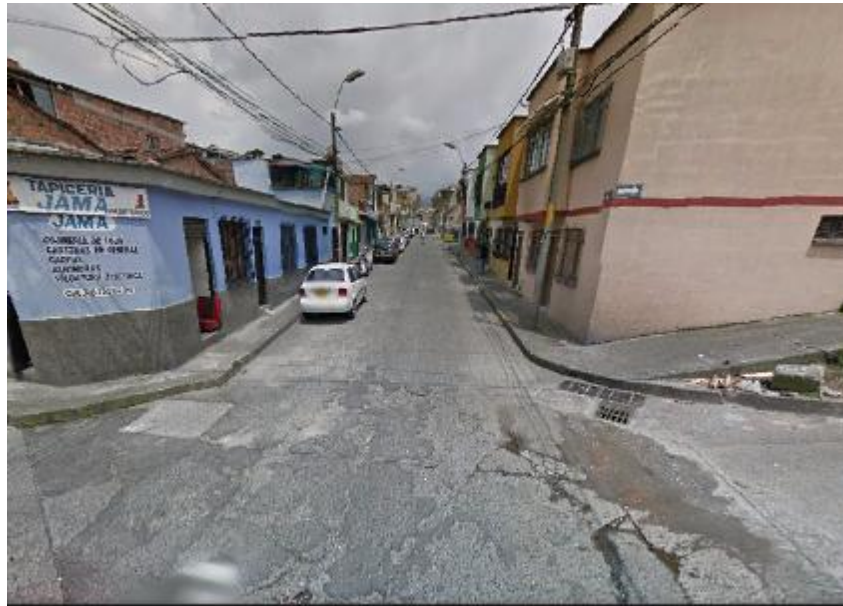
Figura 29. Daños en el pavimento rígido.
