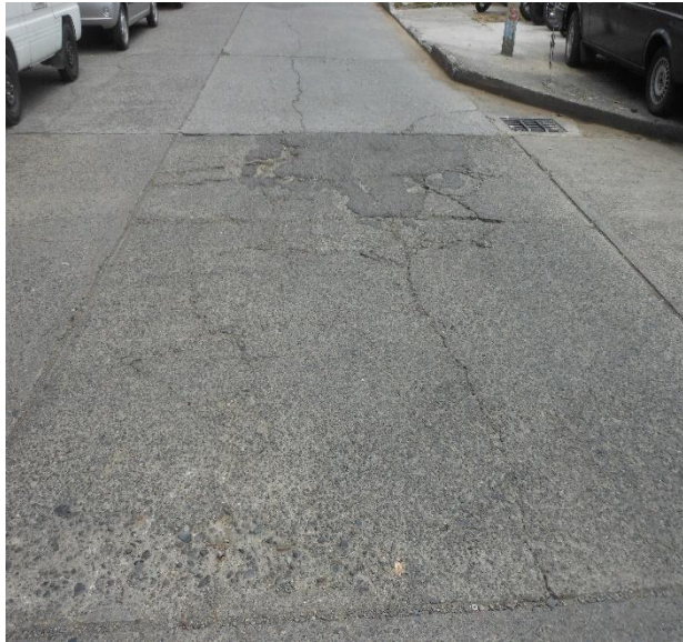
Figura 21. Grieta en bloque.
