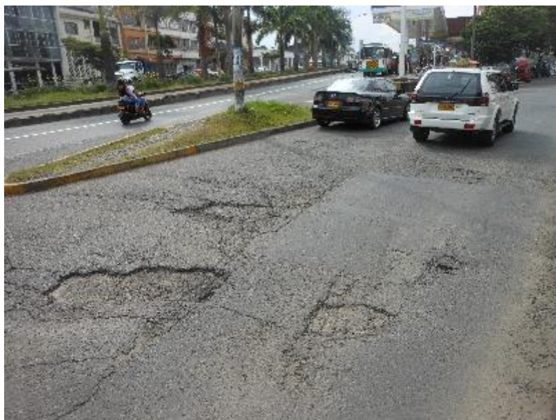
Figura 1. Deterioro de la vía – Cra 12 con calle 25
