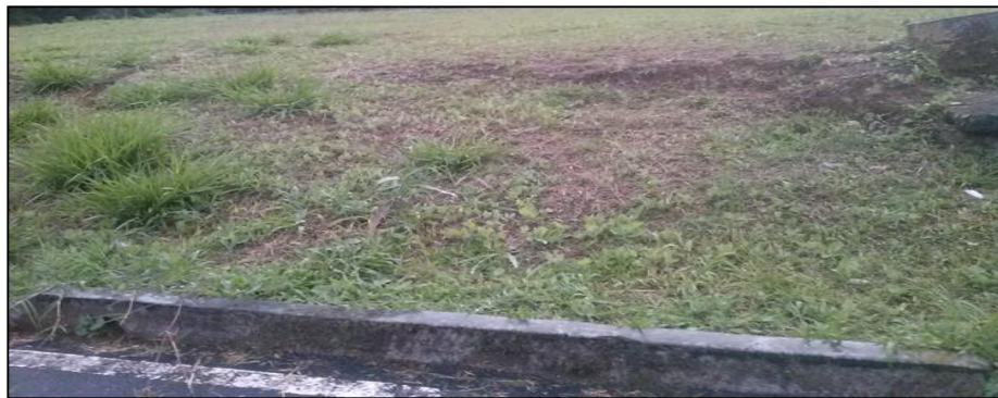
Figura 10. Predio talud Milán (Dosquebradas).
