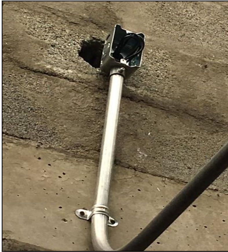
Imagen 28. Instalación eléctrica en mal estado
