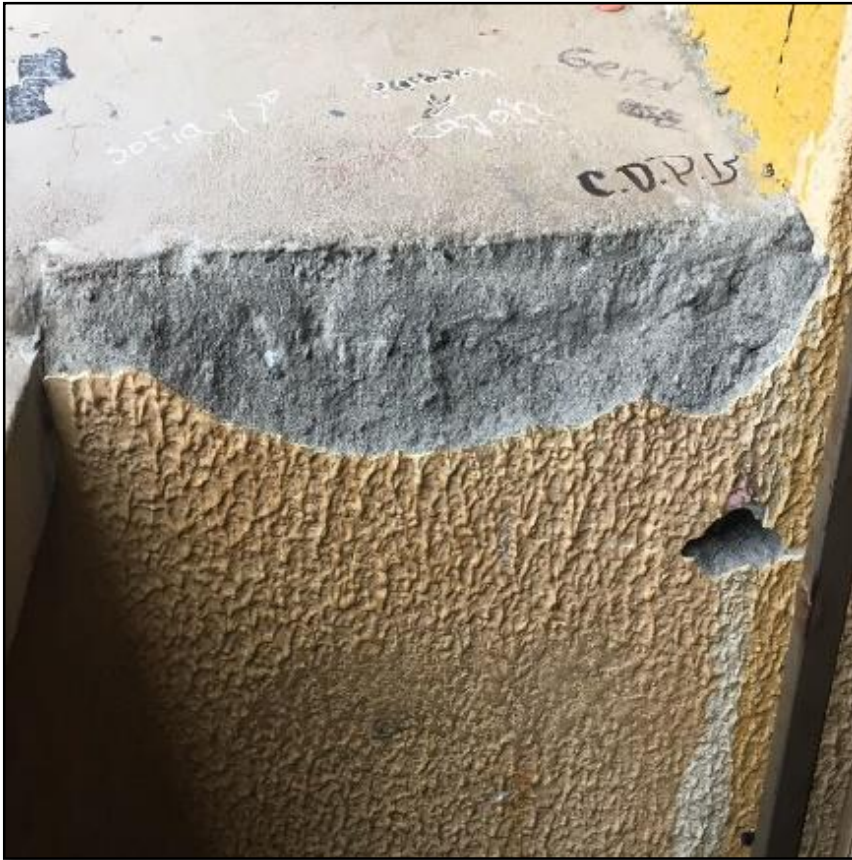
Imagen 24. Desprendimiento en muros
