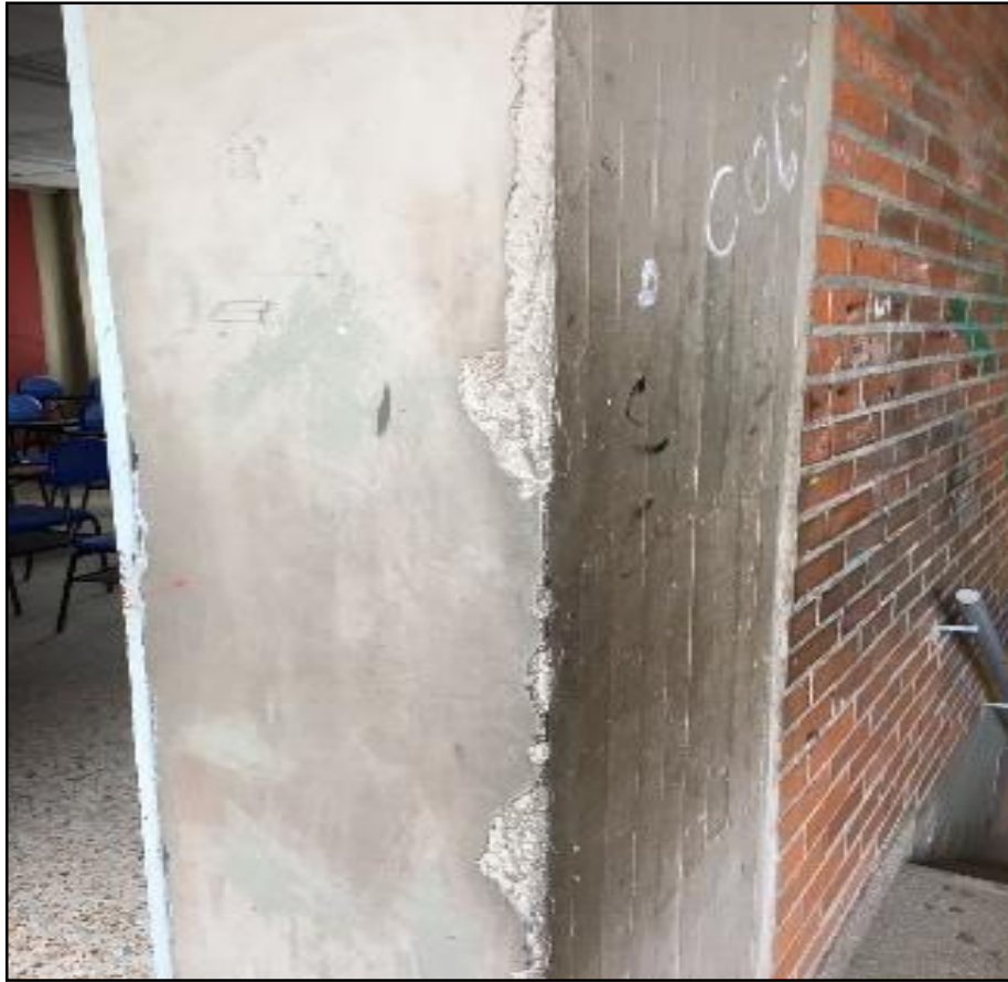
Imagen 19 Desprendimiento en Columna
