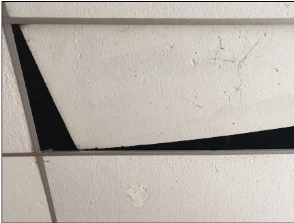
Imagen 25. Cielo raso mal colocado
