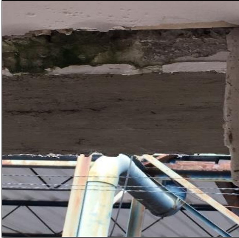
Imagen 27. Humedad en placa de cubierta
