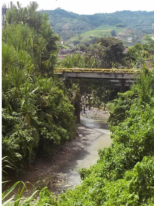
FIGURA 56: Cauce que rebasa la estructura existente
