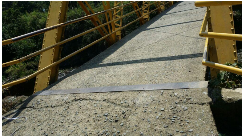
Figura 16. Desgaste en placa de dilatación
