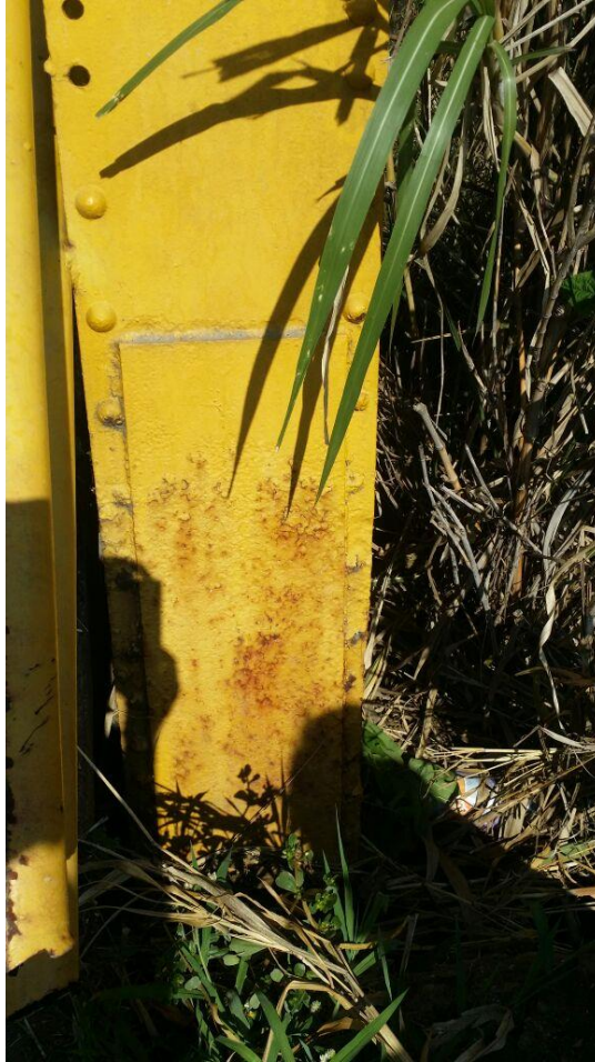
Figura 14. Vegetación y desgaste en viga.
