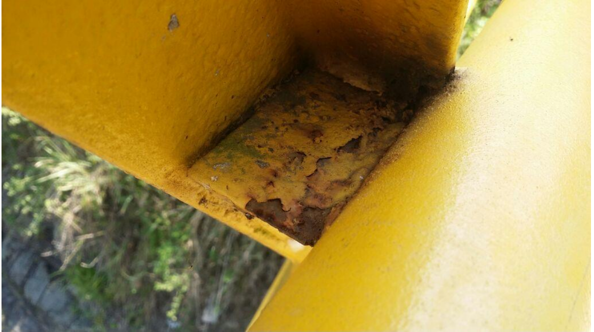
Figura 13. Corrosión y desgaste sobre viga.
