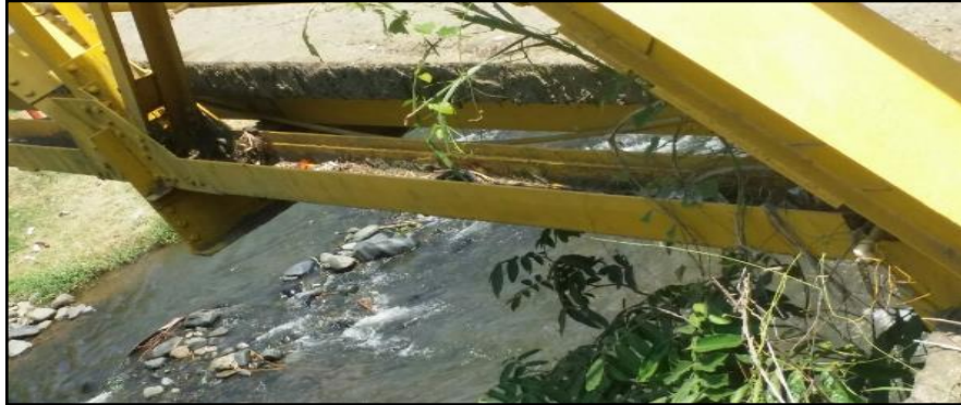
Figura 12. Vegetación sobre la placa de concreto y las vigas
