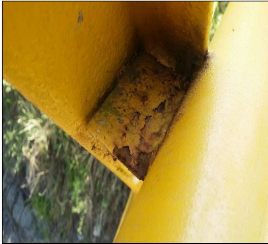
Figura 8. Generación de óxido en uno de los empalmes de las vigas.
