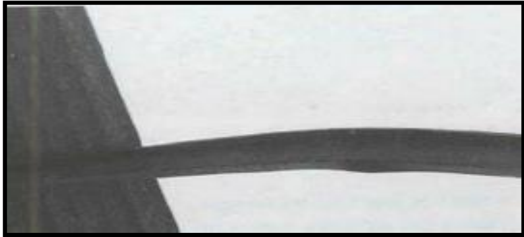
Figura 5.Pandeo correa nave por compresión localizada
