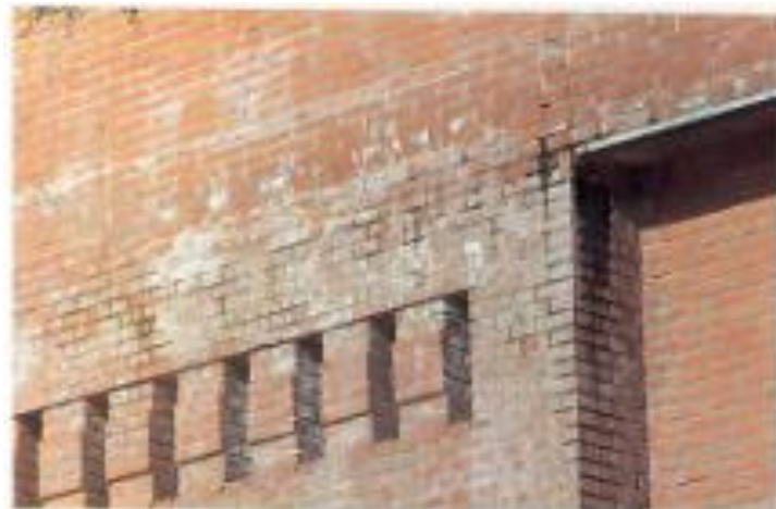
Figura 6. Eflorescencia en fachada
