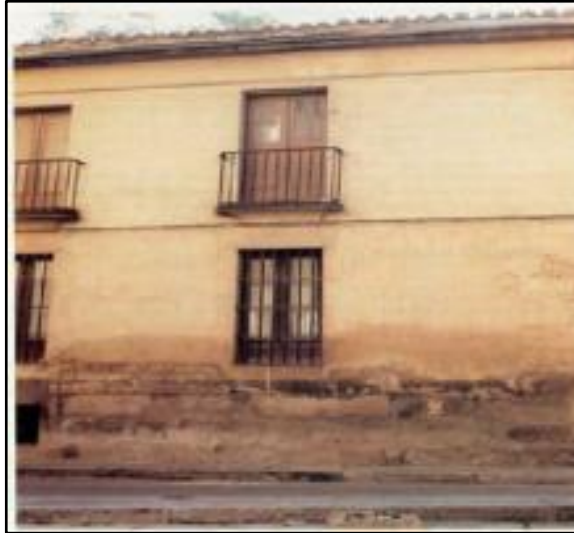
Figura 4. Humedad capilaridad en el arranque muro sobre acera
