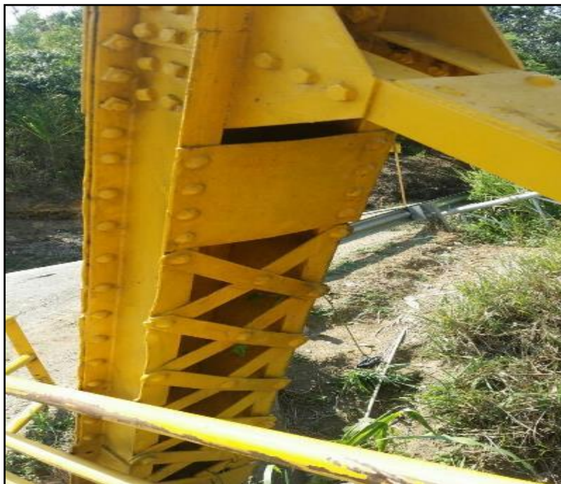
Figura 7. Segmento de una vigueta con la presentación de pandeo.
