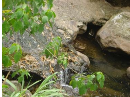
Figura 112. Socavación en disipador de energía
