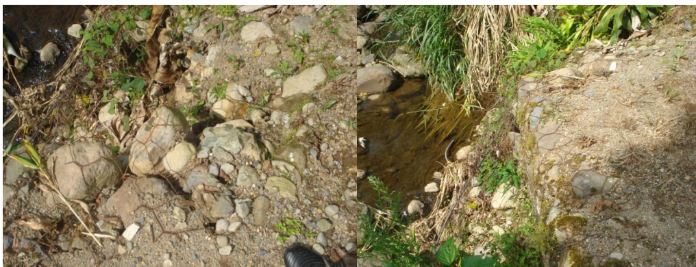
Figuras 108 y 109. Daños en estructura de protección
