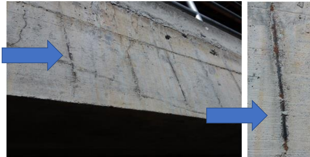
Figura 10. Hierro expuesto en vigas Fuente Propia
