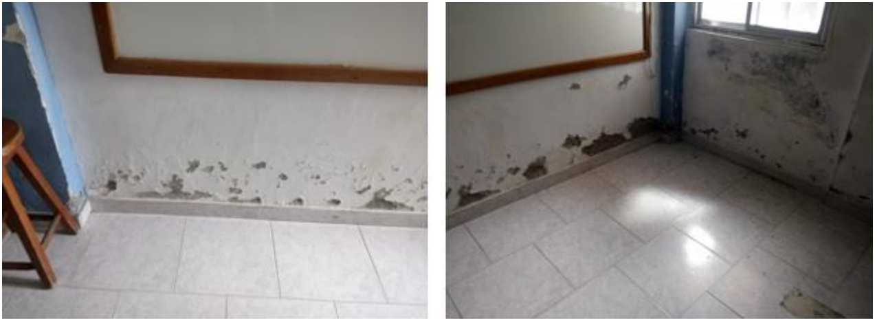
Figura 12. Humedades en paredes Fuente Propia
