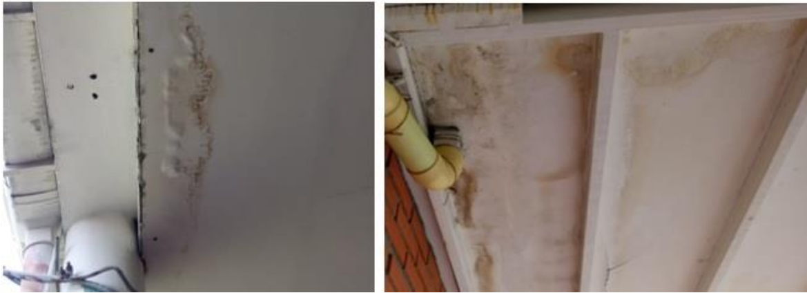
Figura 11. Humedades en cielo rasos Fuente Propia
