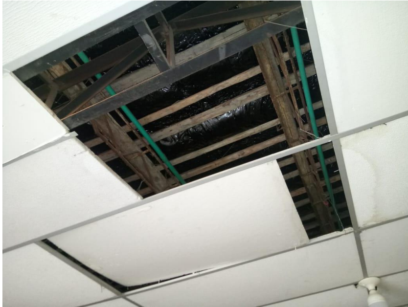
Figura 23. Cielo raso en icopor Fuente Propia
