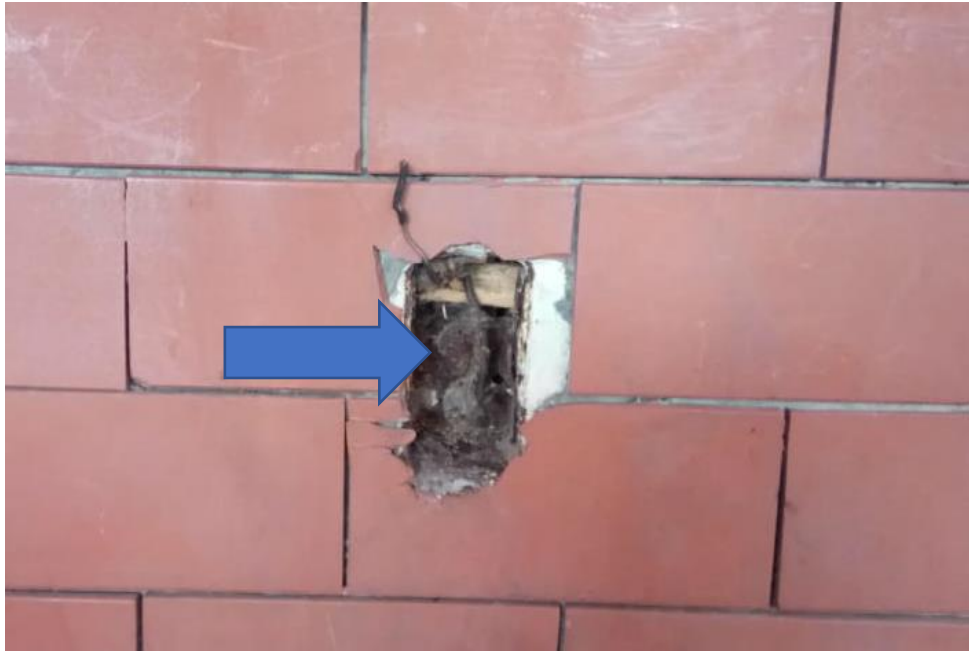
Figura 25. Conexión de Toma Corriente Fuente Propia
