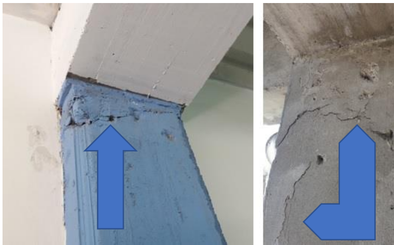
Figura 21. Deterioro de Columnas Fuente Propia
