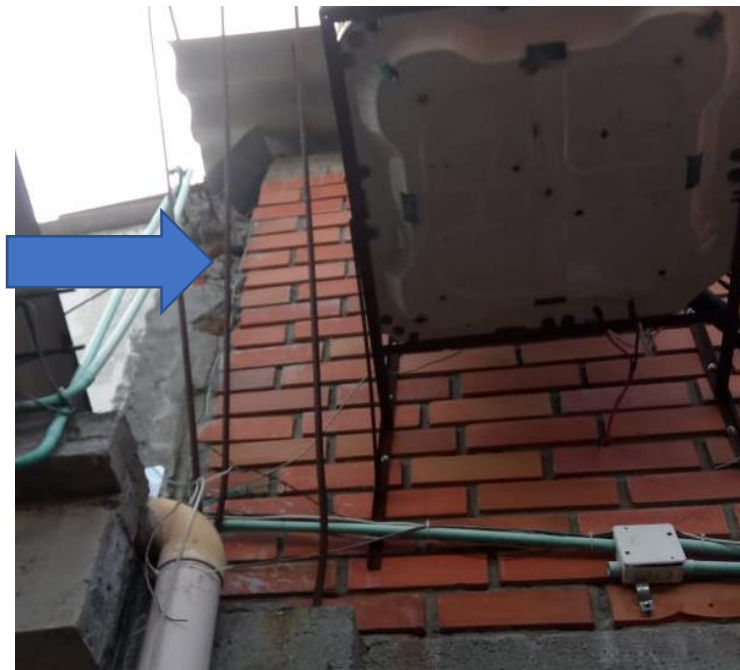
Figura 8. Hierro expuesto en columna Fuente Propia
