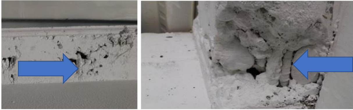
Figura 9. Hierro expuesto en vigas Fuente Propia
