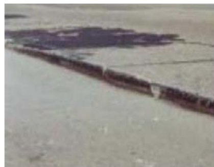
*Tomada de "Catálogo Centroamericano de daños en pavimentos viales", Consejo de Ministros de Transporte de Centroamérica. Guatemala. 2003.
