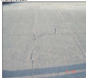
Fotografía 4. Vista típica de una Grieta Transversal.
