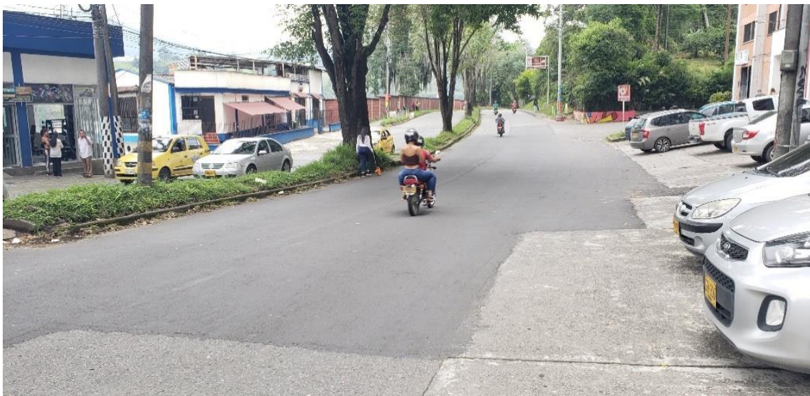
Figura 16. Tramo sin andén para el peatón (Fuente: Los Autores de la investigación)
