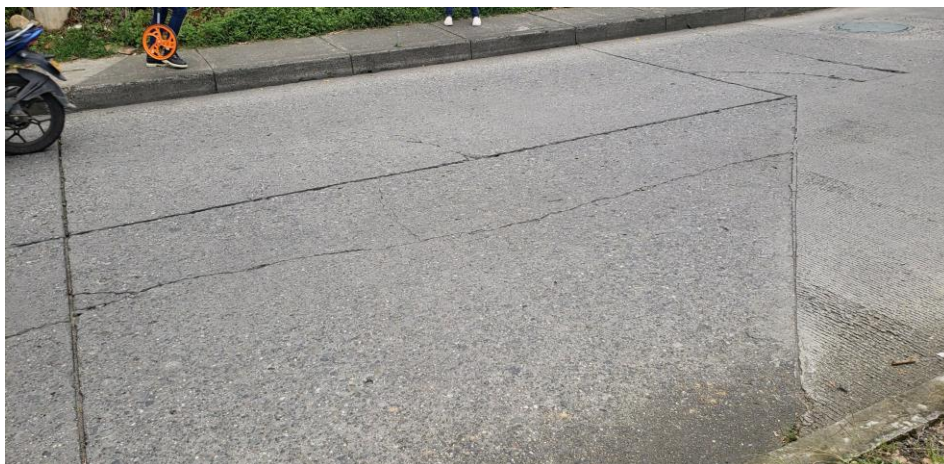
Figura 6. Parches, grietas transversales y longitudinales, severidad media y baja (Fuente: Los Autores de la investigación)
