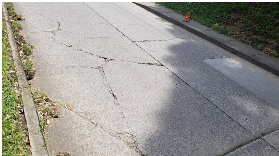
Figura 9. Deterioro levantamiento localizado longitudinal, grietas en bloque (Fuente: Los Autores de la investigación)
