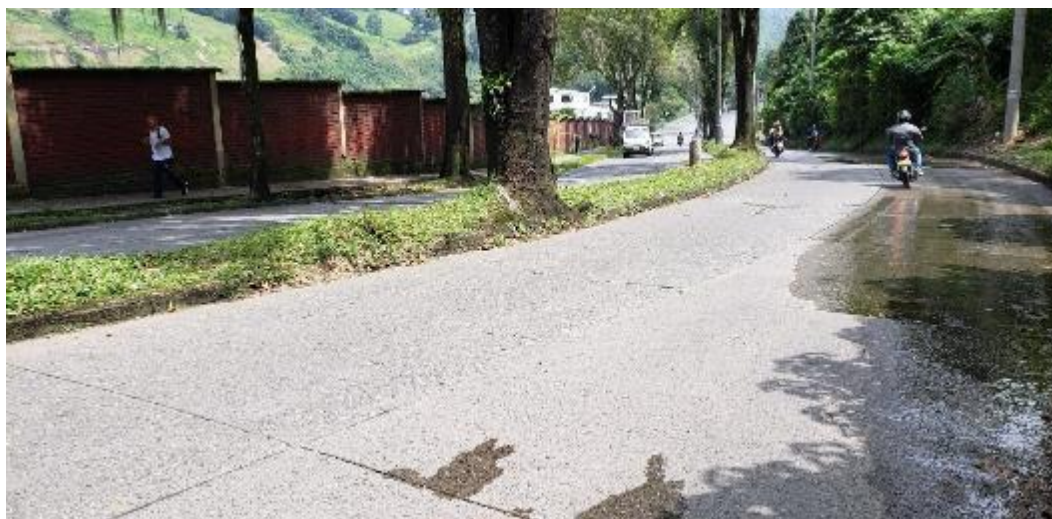
Figura 26. Falta de señalización vial (Fuente: Los Autores de la investigación)
