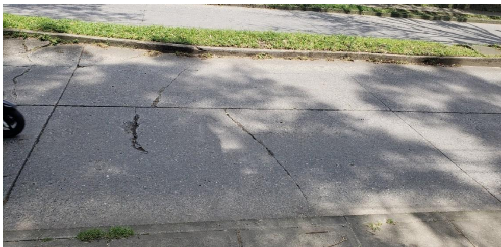
Figura 7. Superficial levantamiento localizado longitudinal, grietas transversales (Fuente: Los Autores de la investigación)
