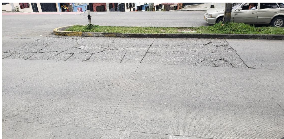
Figura 5. Grietas en bloque, deterioro superficial pulimiento, severidad alta (Fuente: Los Autores de la investigación)
