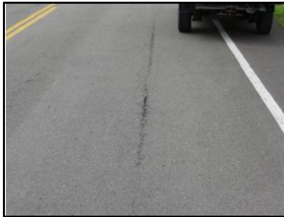
Fotografía 13. Fisura Longitudinal, severidad alta
