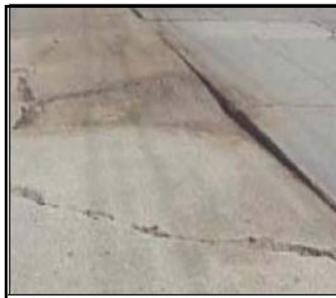
Fotografía 11. Hundimiento de losa y su posterior agrietamiento
