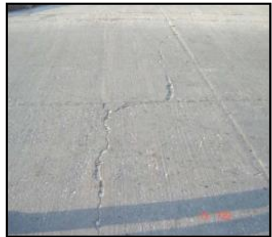
Fotografía 4. Vista típica de una Grieta longitudinal
