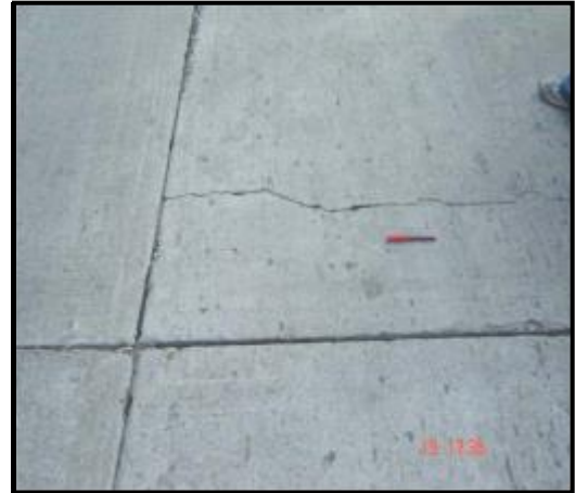
Fotografía 5. Vista típica de una Grieta en los extremos de los pasadores.
