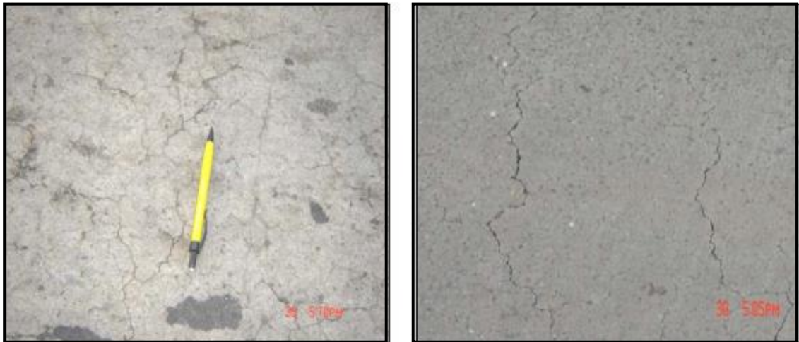
Fotografía 12. Fisuración por retracción típica con nivel de severidad bajo
