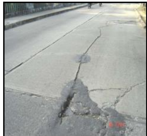
Fotografía 6. Vista típica de las Grietas en bloque
