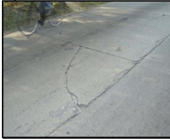
Fotografía 2. Vista típica de una Grieta de Esquina
