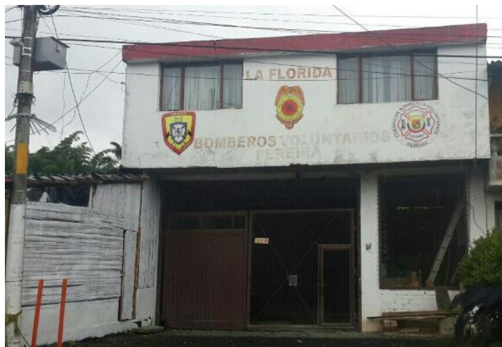
Imagen 7. Estado de las instalaciones del cuerpo de bomberos del Corregimiento de La Florida.
