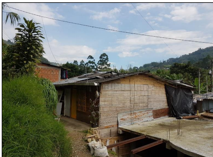
Imagen 9. Vivienda en madera en condición de vulnerabilidad sísmica en la Vereda Gaitán Bajo.
