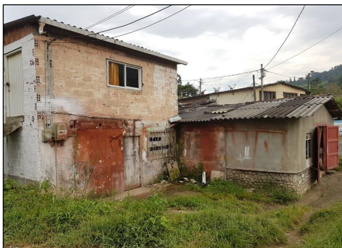
Imagen 10. Vivienda con daños e irregularidades estructurales en la Vereda Gaitán Bajo.
