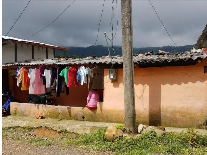
Imagen 8. Presencia de daños en vivienda corregimiento de la Florida.
