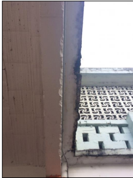
Imagen 11. Estado actual de las vigas en la institución de Antonia Santos.
