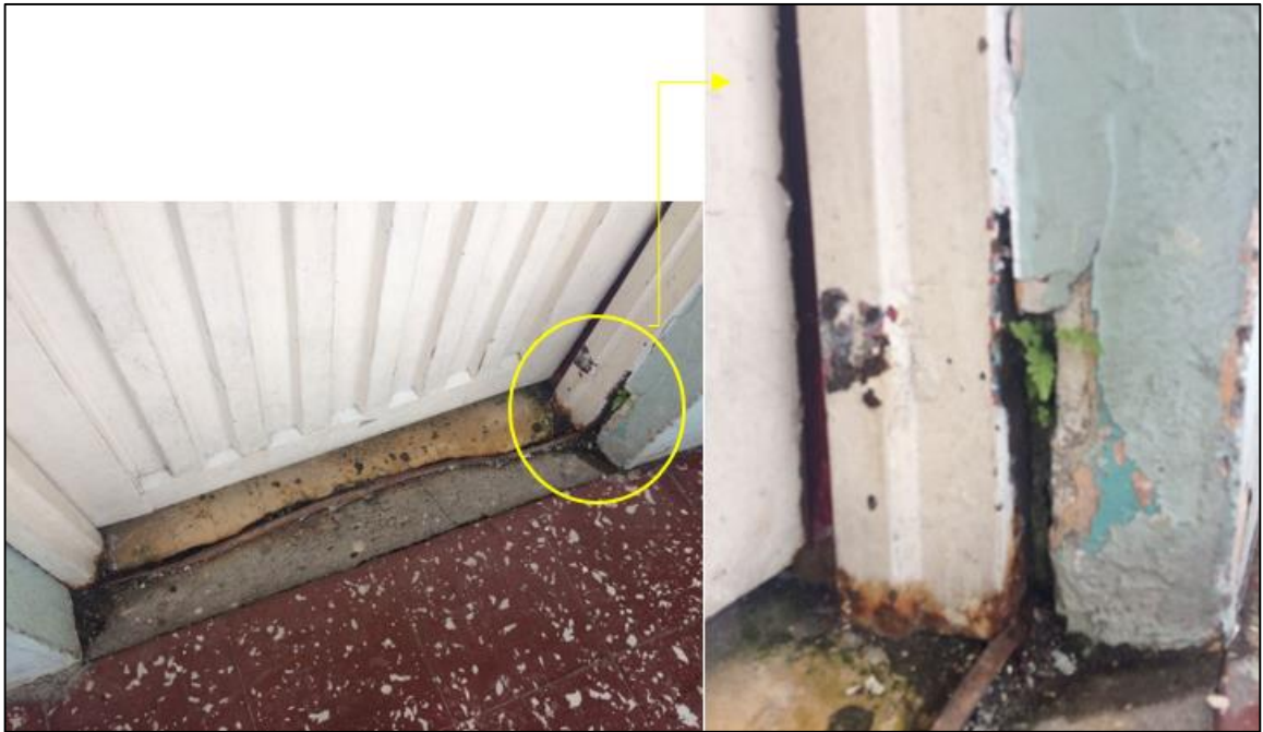
Imagen 18. Crecimiento de materia biológica en la estructura de la institución educativa Antonia Santos.
