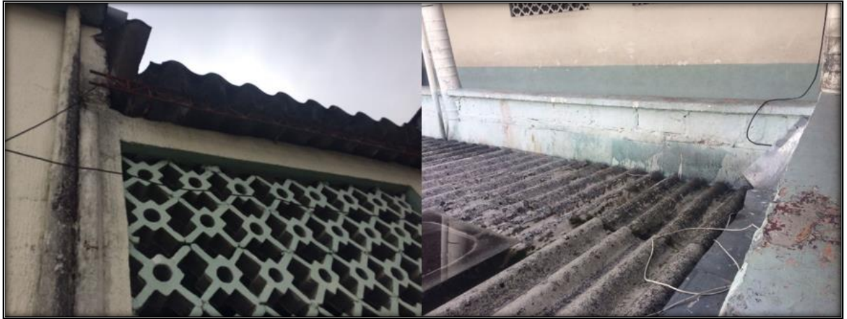
Imagen 14. Cubierta con ausencia de sistema de drenaje de las aguas lluvias.
