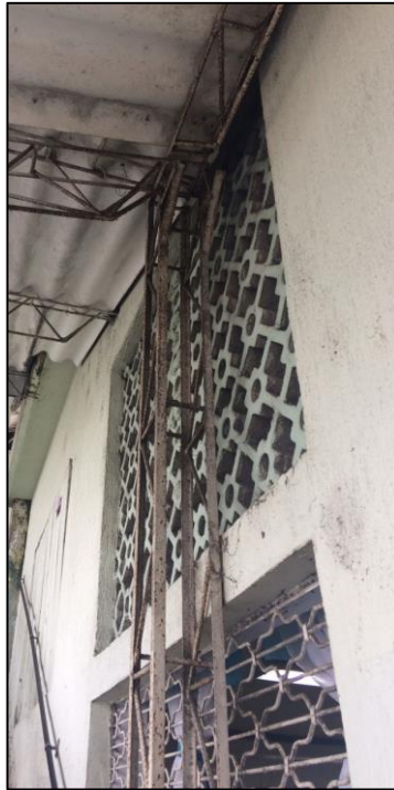
Imagen 7. Corrosión en los elementos metálicos.
