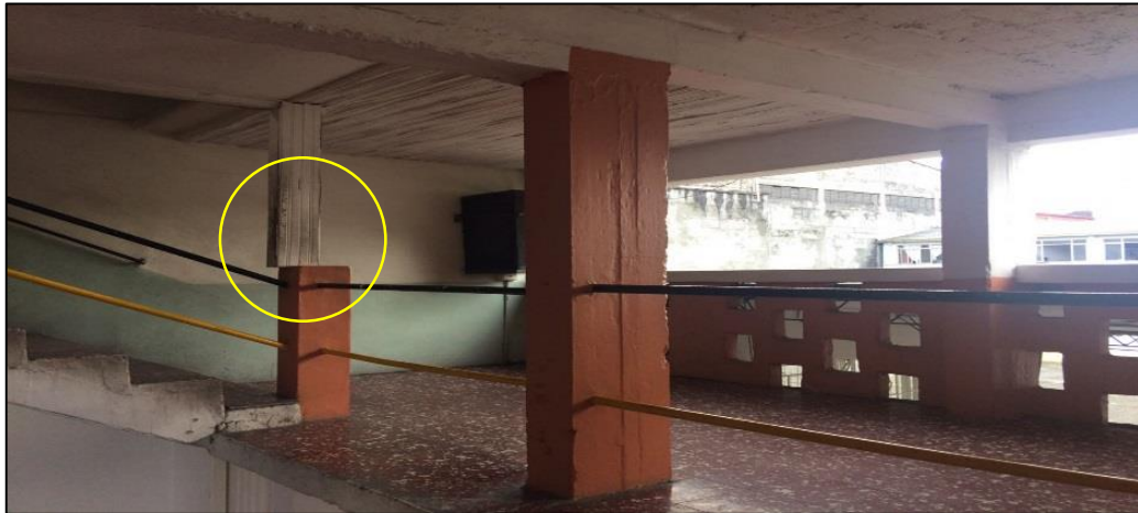
Imagen 6. Discontinuidad en una columna central en la institución Antonia Santos.
