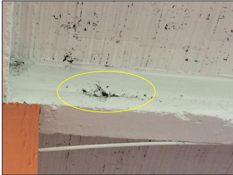
Imagen 9. Estado de las vigas en la institución
