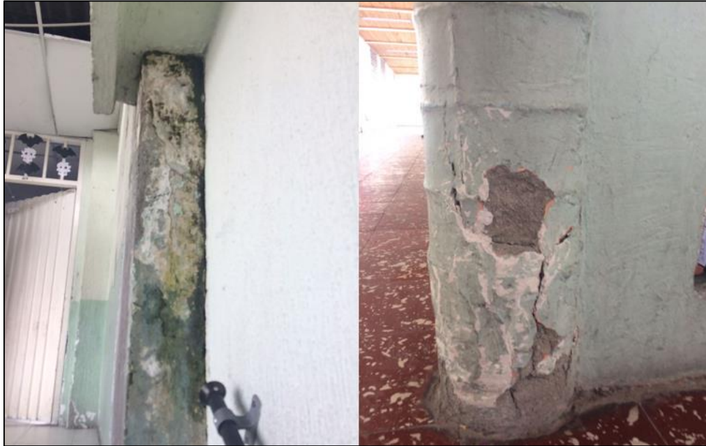
Imagen 4. Estado de las columnas en la institución Antonia Santos.
