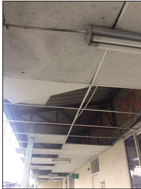
Imagen 19. Estado actual de los acabados.
