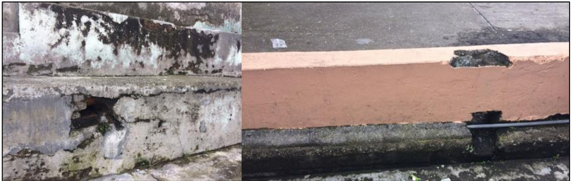
Imagen 17. Cráteres en los elementos estructurales de la edificación Antonia Santos.
