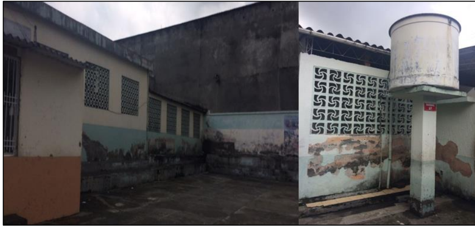
Imagen 13. Estado actual de los muros.
