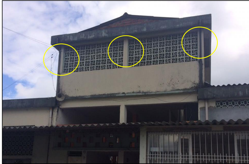
Imagen 5. Fenómeno de columna corta en el segundo piso de la edificación Antonia Santos.
