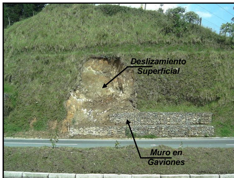
Figura 2. Detalle de deslizamiento superficial en talud estabilizado
