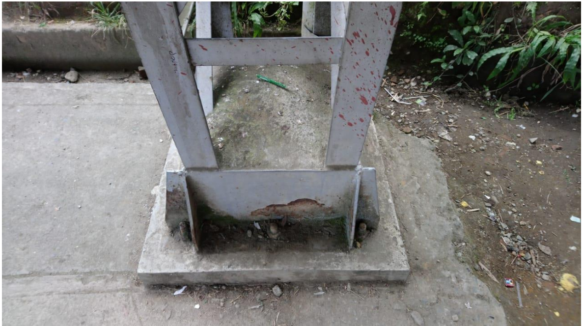
Figura 29: Corrosión en Elementos metálicos.
