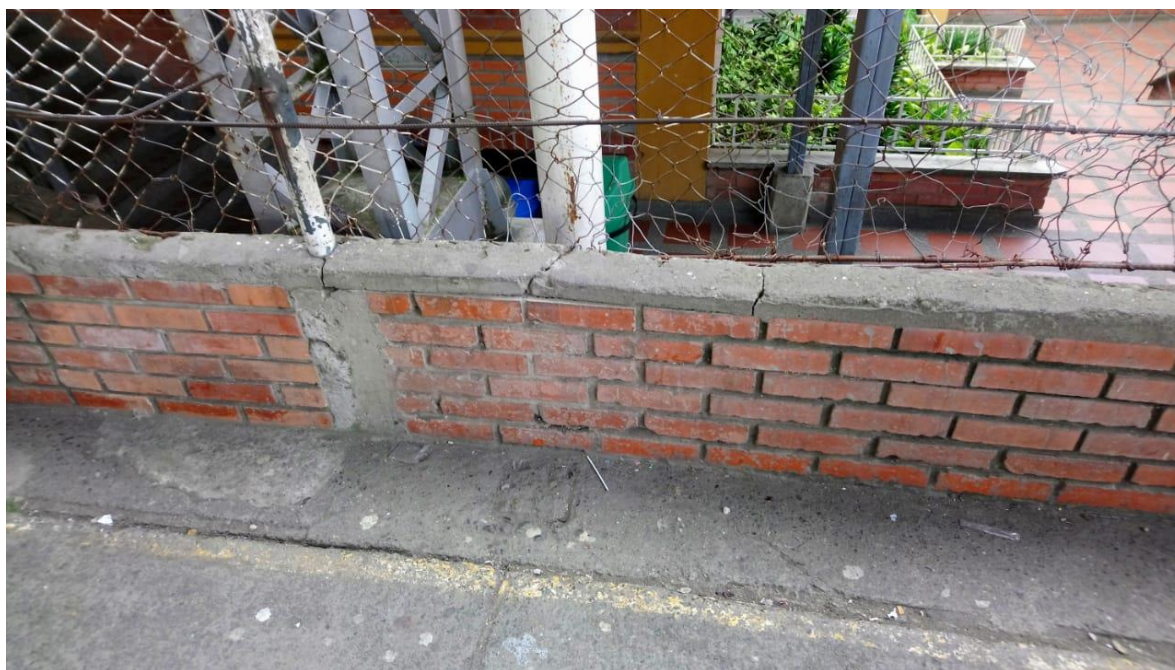
Figura 32: Fisuras en alfajías y muros de cancha
