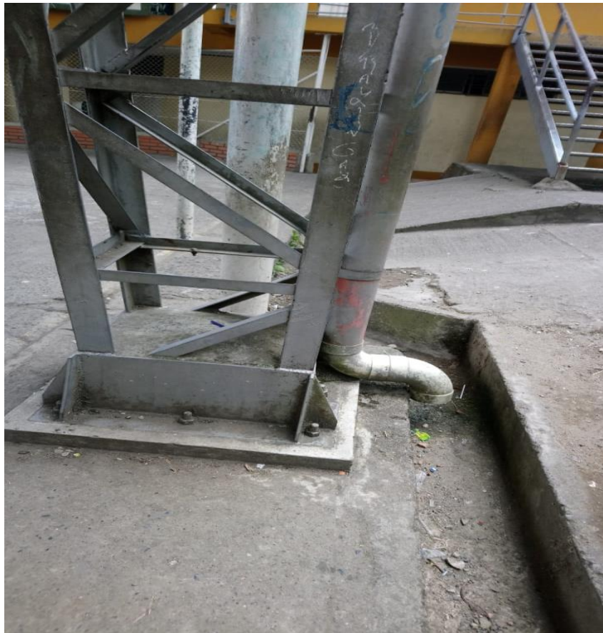
Figura 26: Canal aguas lluvias deteriorado.
