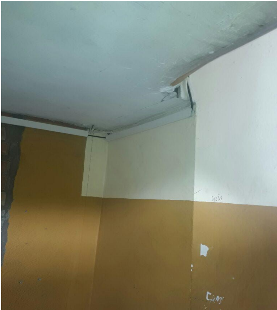
Figura 34: Humedad cielo falso
