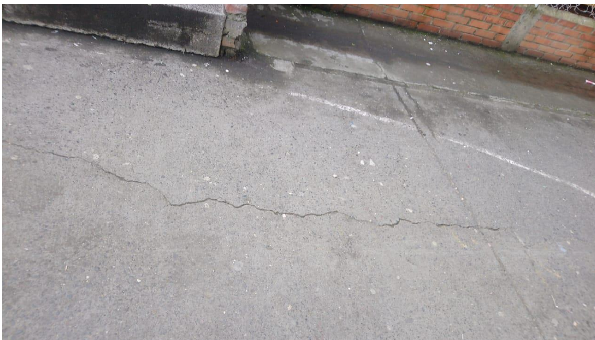
Figura 35: Grietas en cancha.
