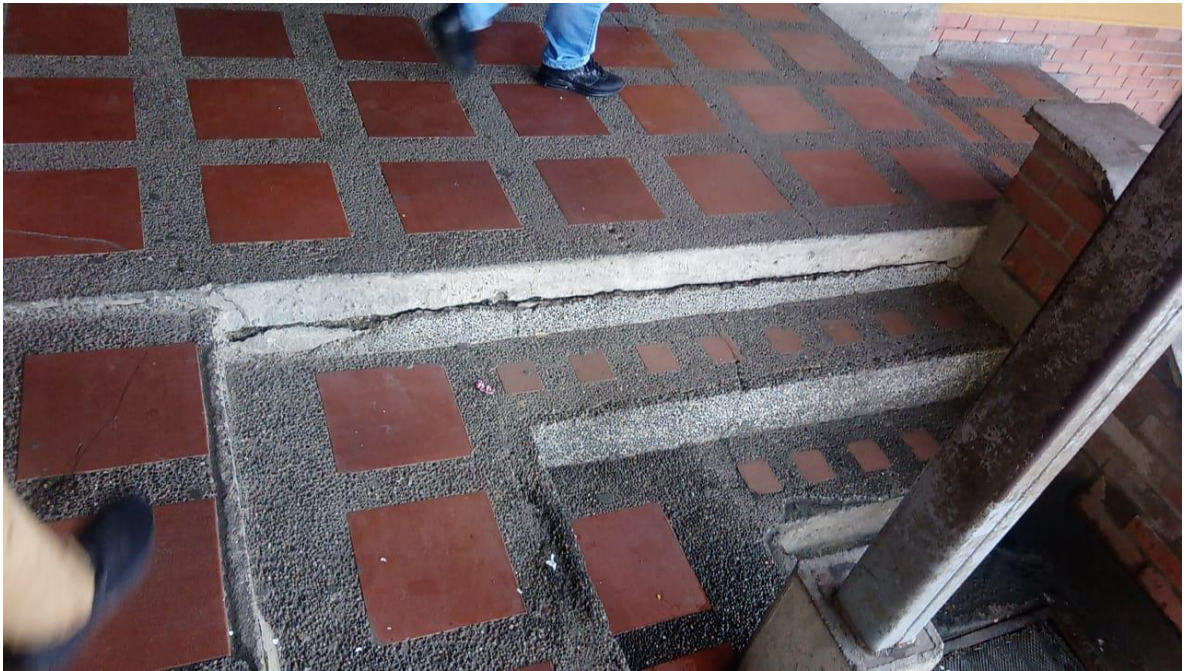
Figura 30: Fisuras y Grietas escalas en concreto.
