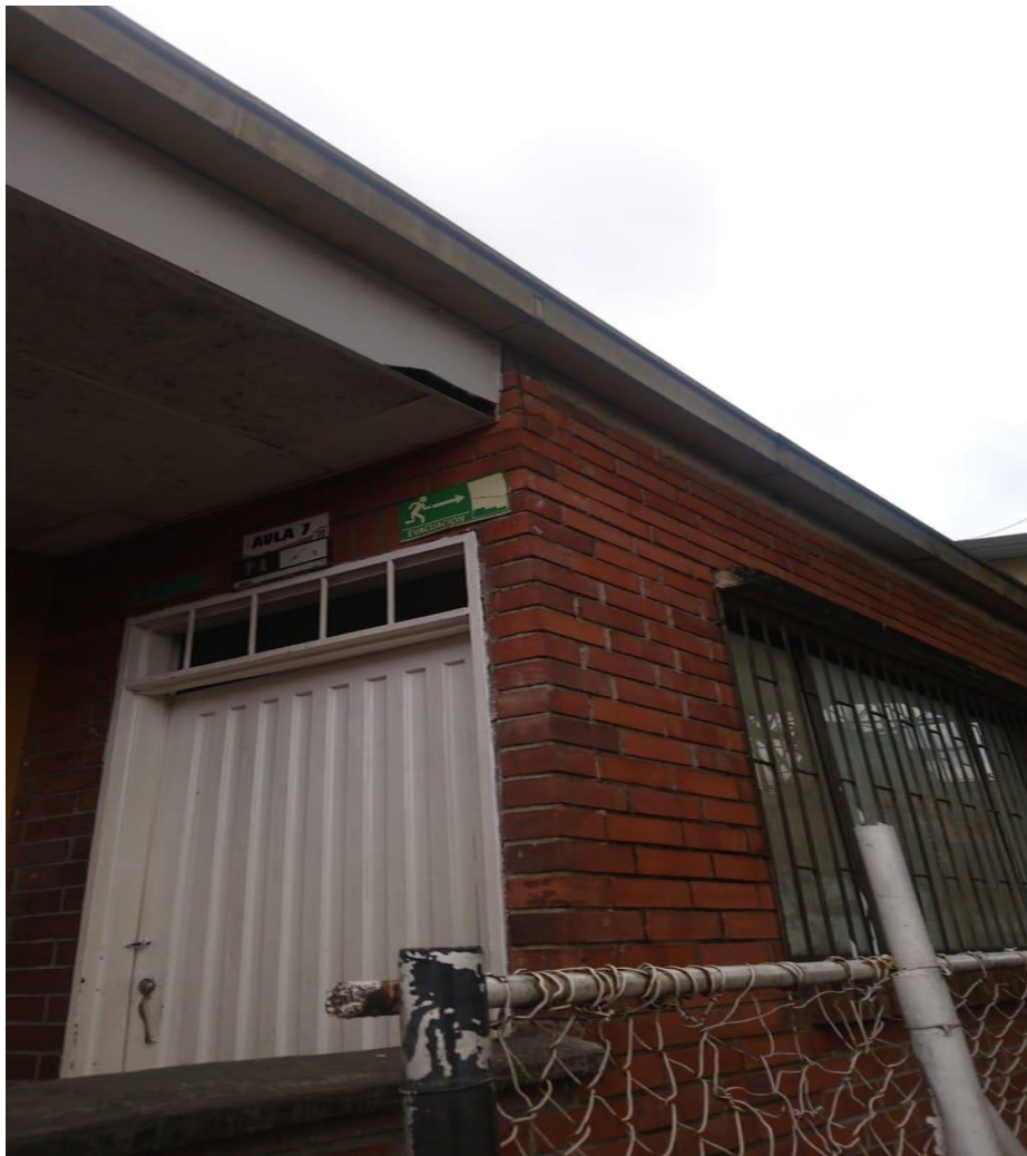
Figura 31: Cielo raso sin una parte
