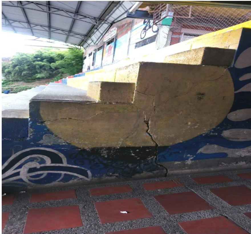
Figura 27: Grietas en gradas.
