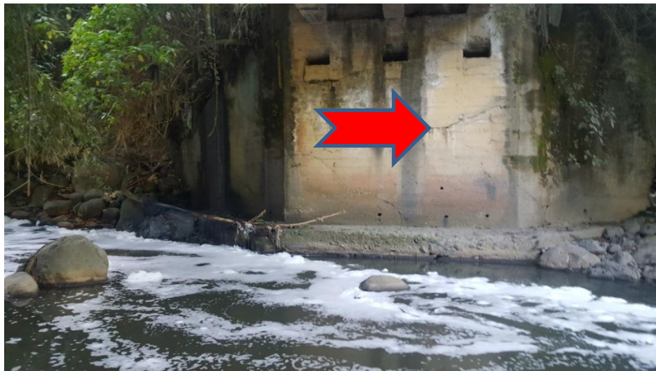
Figura 3. Pilar base de la estructura con fractura en estribor. Elaboración propia.
