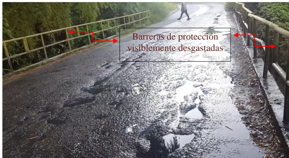
Figura 5. Parte superior del puente con desgaste de la capa de rodadura. Elaboración propia.
