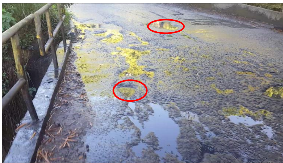
Figura 4. Deterioro en la capa asfáltica- empozamiento de agua posible penetración en la losa. Elaboración propia.
