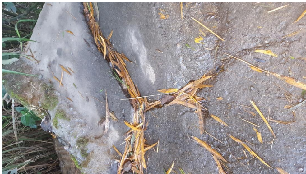
Figura 6. Fisuras en el concreto. Elaboración propia.
