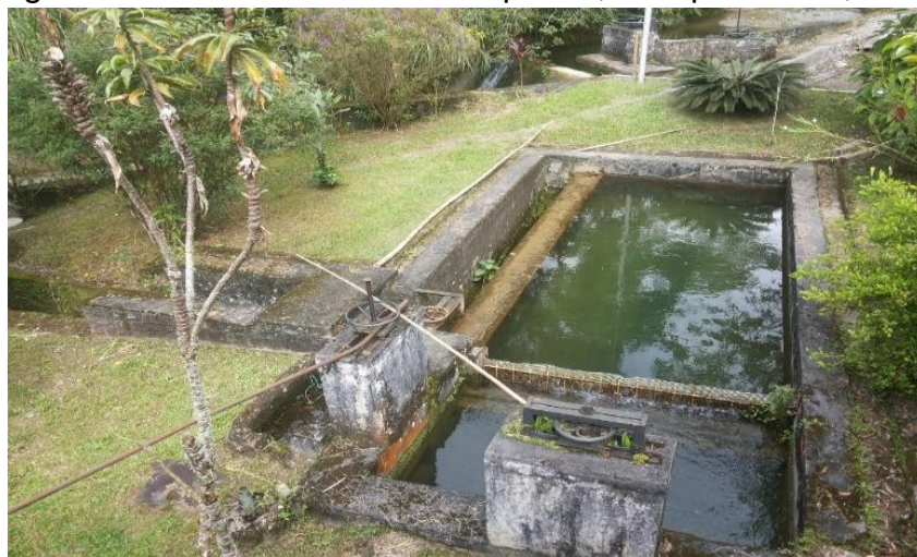
Figura 16: Desarenador visto en planta, Dosquebradas, 2014.
