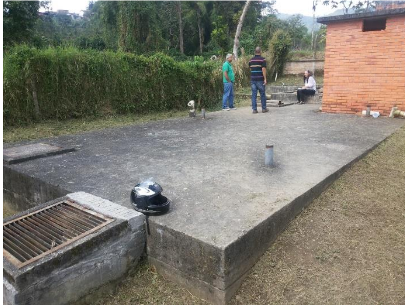
Figura 20: Tanque de almacenamiento, Dosquebradas, 2014.
