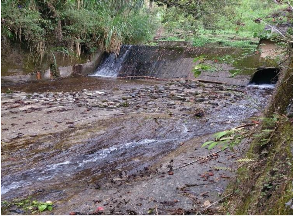
Figura 14: Bocatoma del acueducto, Dosquebradas, 2014
